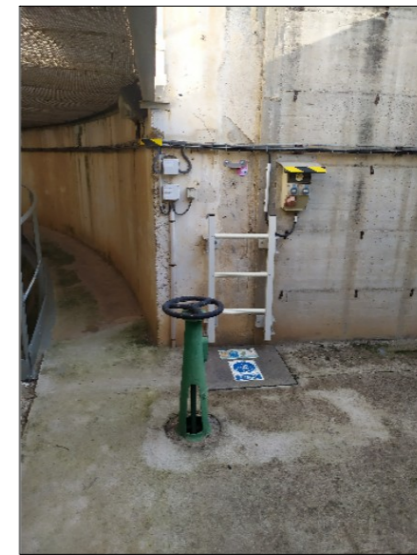
ARQUETA SIMPLE VÁLVULA DESGUÀS DECANTADOR Nº 7
