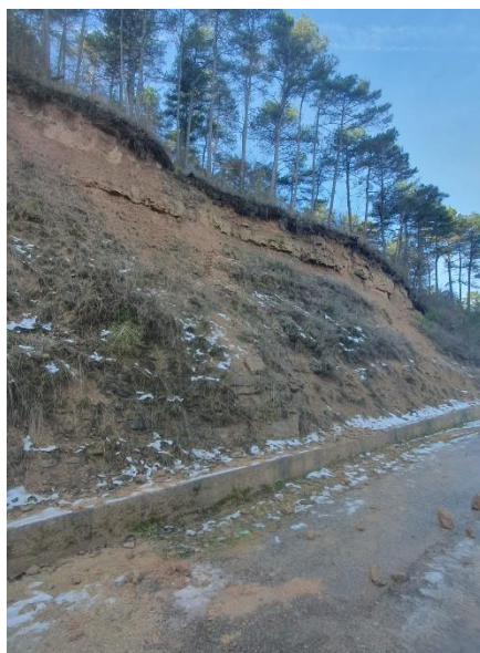
Imatge talús núm. 2 amb els petits desprendiments ocasionats
