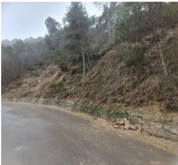
Imatge talús núm. 1 amb els petits desprendiments ocasionats
