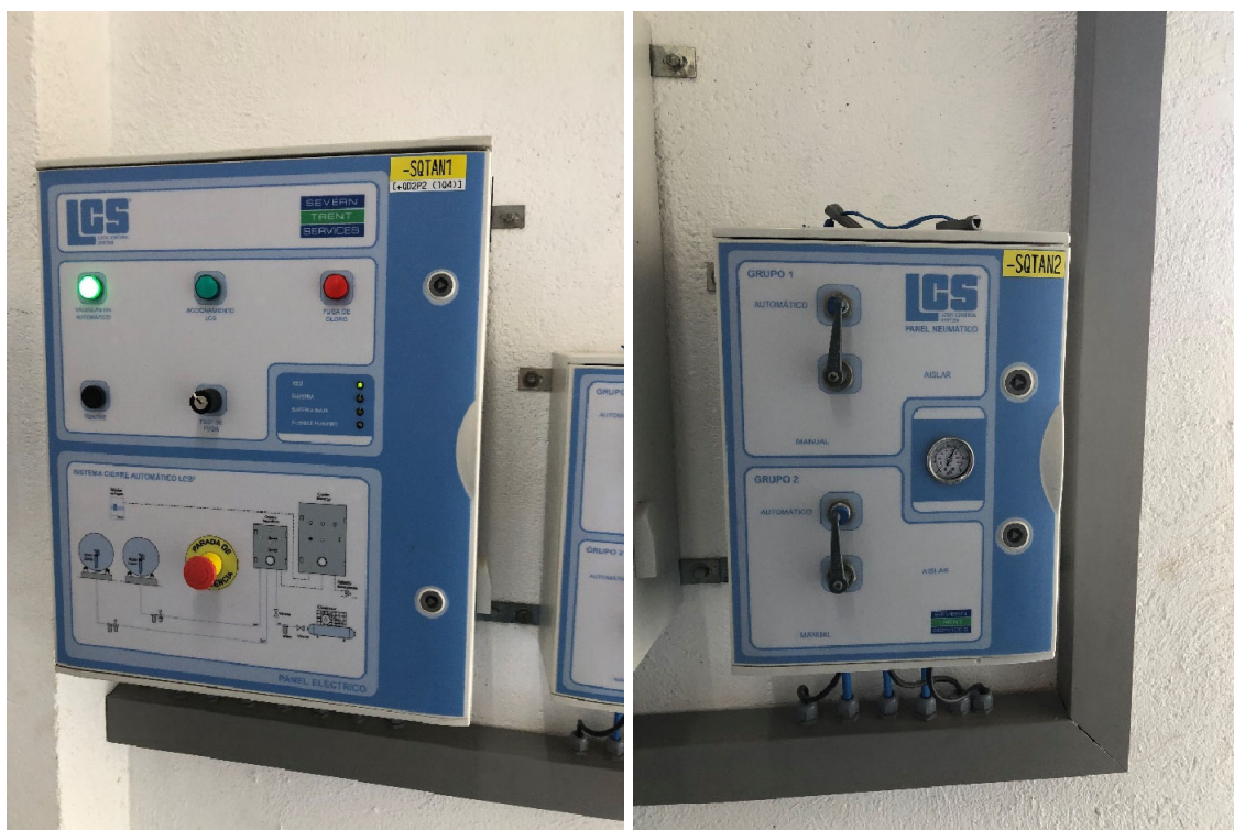
Figura 4. Quadres sistema tancament automàtic i panell accionament pneumàtic
