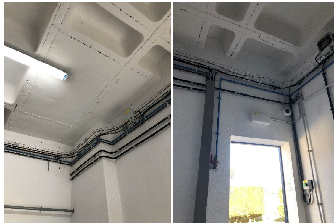
Figura 5. Vista envà exterior i pas instal·lacions
