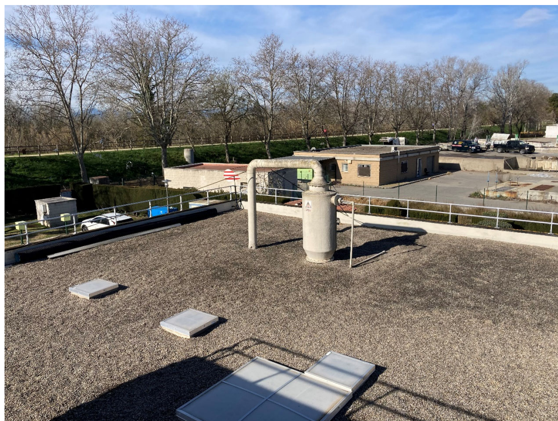
Figura 12. Vista conductes exteriors i torre del sistema de neutralització de fugues
