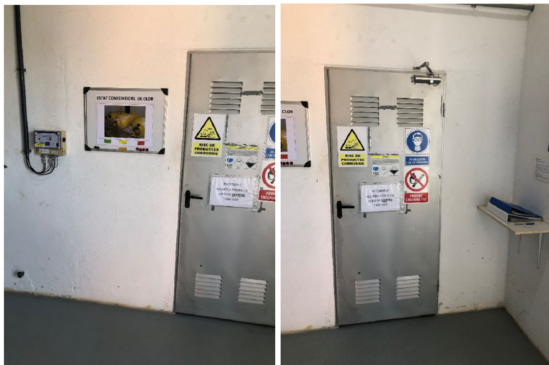
Figura 3. Vista porta accés a sala contenidors clor gas des de sala dipòsit sosa
