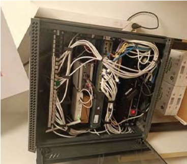
Rack informàtic existent
