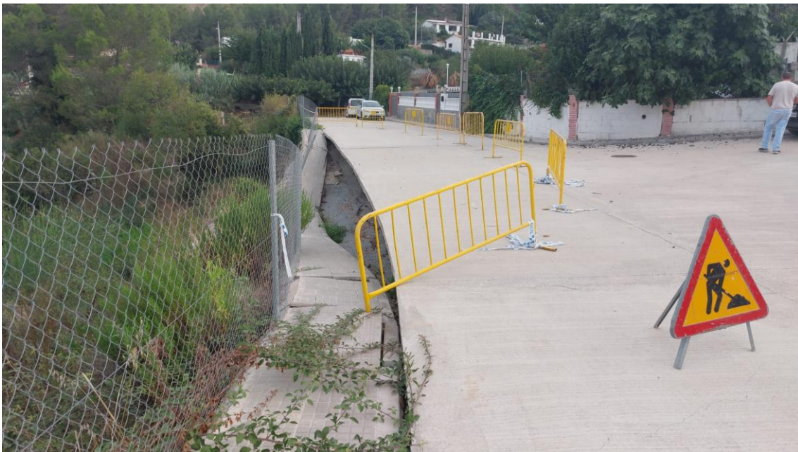
Imatge 1-1 - Estat post-col·lapse [Font: Windmill Structural Consultants]
