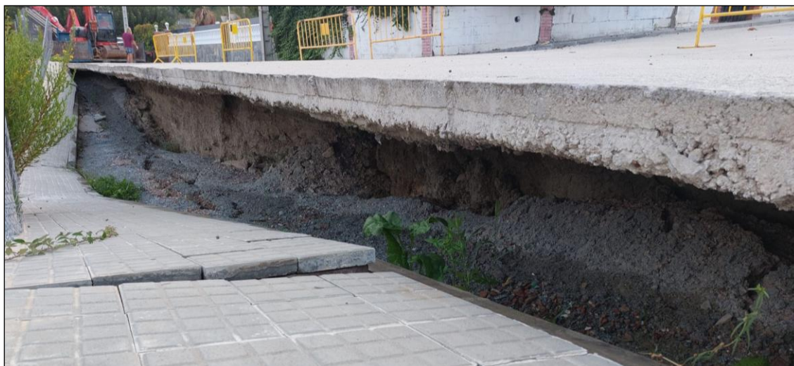
Imatge 1-1. Estat original despès del fenomen d'inestabilitat.
