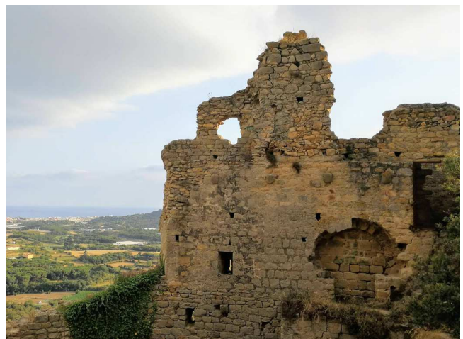
Ejemplo de muro con necesidad de saneamiento
