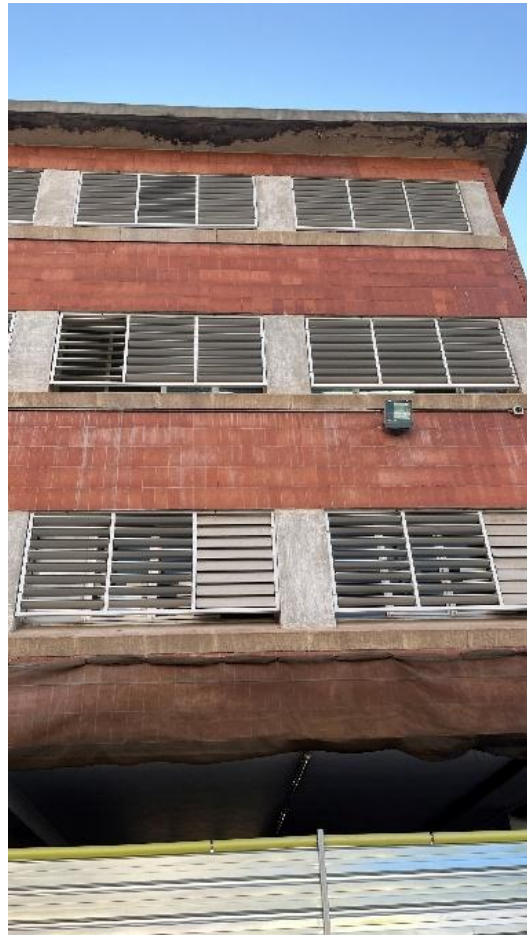
APLACATS CERÀMICS A REPARAR
