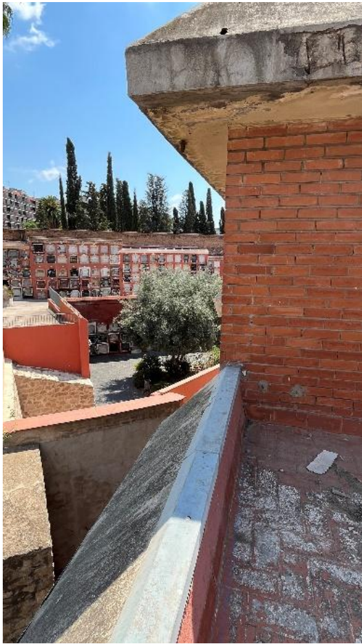
RÀFECES A REPARAR
