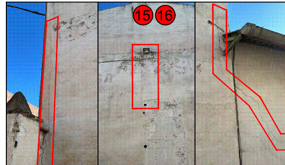
15_ Grapat d'esquerdes existents - NAU 2 16_ Reparació de revestiment existent - NAU 2
