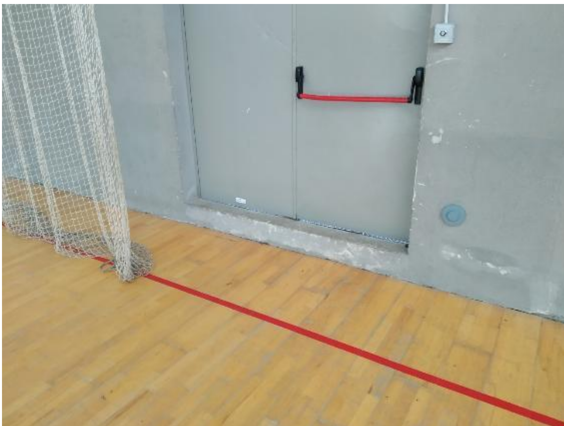
Desnivell paviment existent amb sortida d'emergència.
