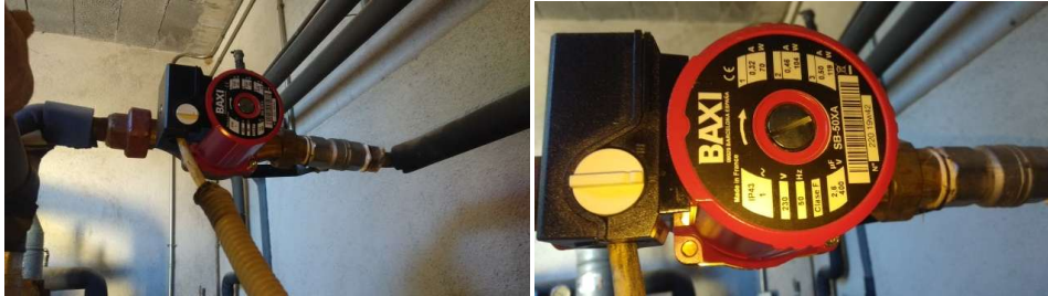
Bomba recirculació primari 1 Baxi SB-50XA
