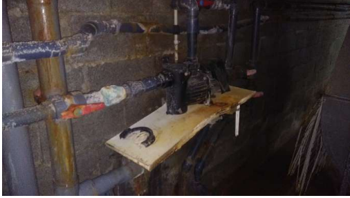
Bomba de recirculació clor 1
