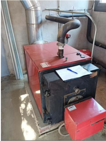
Imatge 1. Caldera de gasoil del CEIP (Font: Energi)
