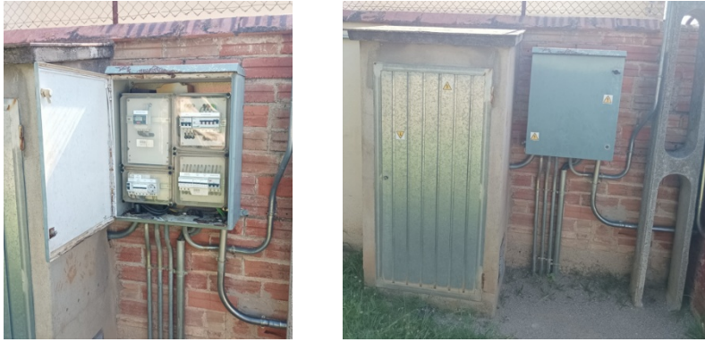
Imatge 8 i 9. Quadre principal CEIP i caseta de l'autotransformador i inversor FV (Font. Energi)
