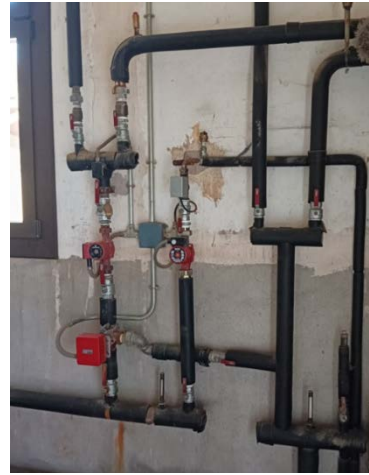
Imatge 2. Instal·lació hidràulica sala calderes (Font: Energi)
