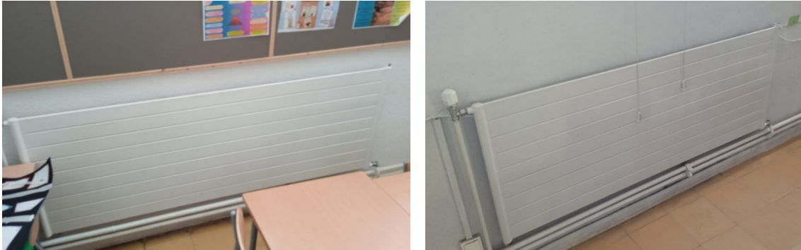
Imatges 3 i 4. Radiador de panells d'acer a interior aules (Font: Energi)
