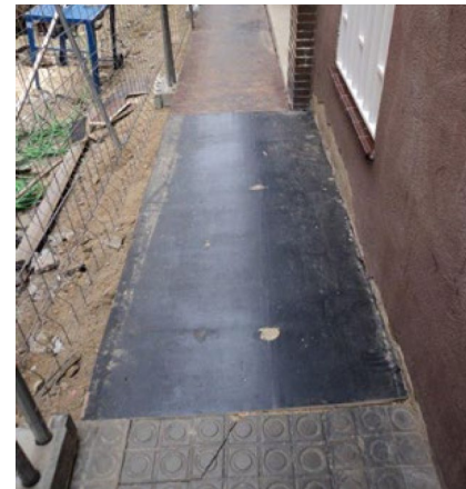
Imatge 1. Mostra de col·locació de planxa de protecció en rasa o pou.
