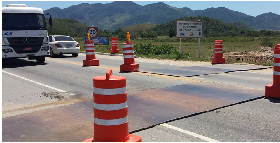
Imatge 3. Mostra de placa de ferro per a cobertura de rases apta per al pas de vehicles.
