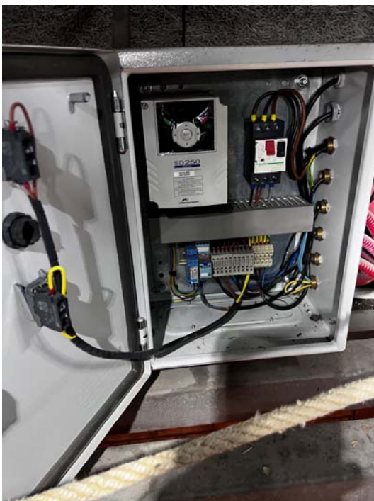
Control de telón cortafuegos desconectado
