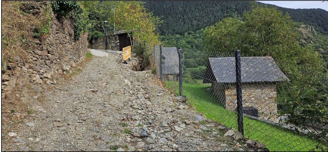
Il·lustració 3: Vista del muro colapsado desde la calzada de Carrer Còsta
