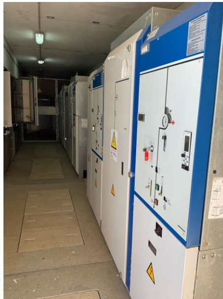
Il·lustració 2 : Aparaments elèctrica a l'interior del CM 64.011
