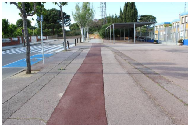
Vorera est. Estat de conservació del paviment. Font: CCC 08/09/2025
