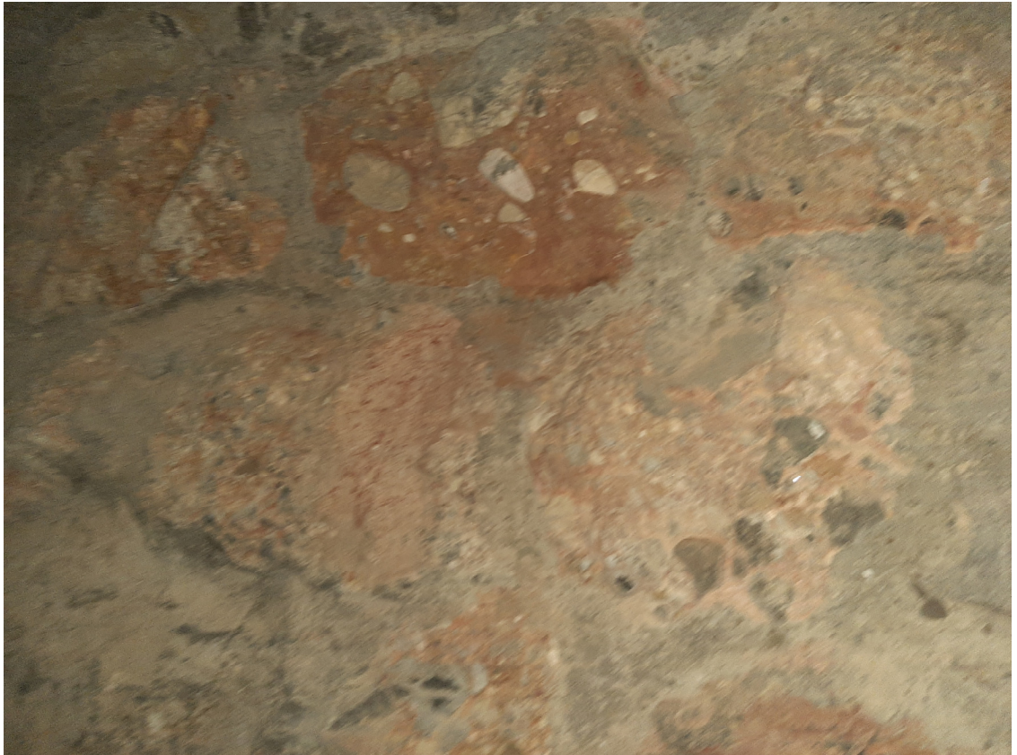
Imatge 19. Desgast de carreus
