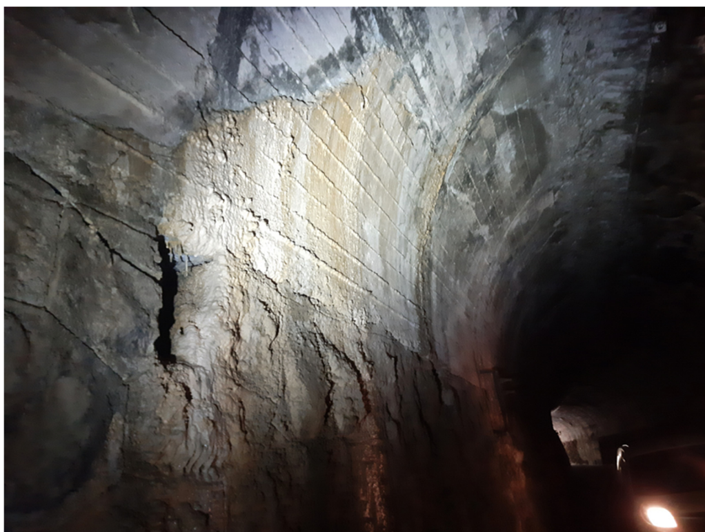
Imatge 22. Regalims i precipitacions de calç en zona propera a drenatge
