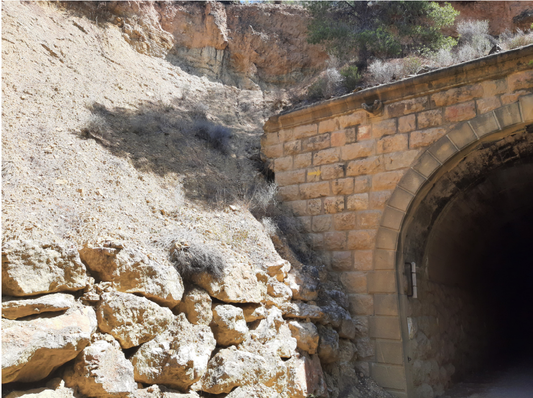
Imatge 7. Boca Sud de túnel H. Pèrdua de recolzament
