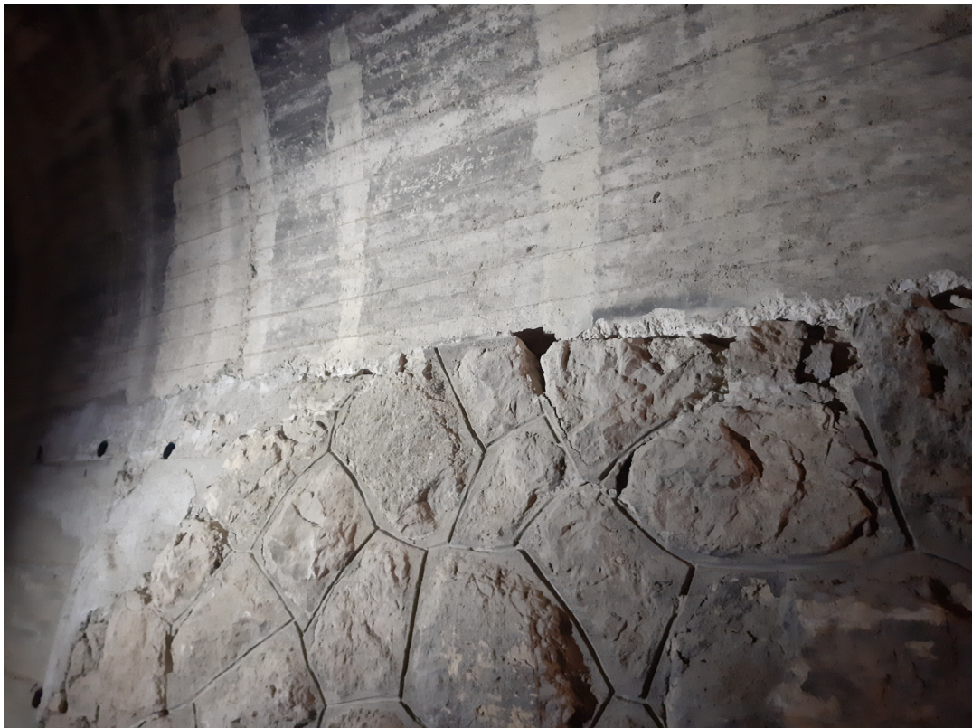
Imatge 23 i 24. Dany apareguts al costat d'un dany reparat anteriorment
