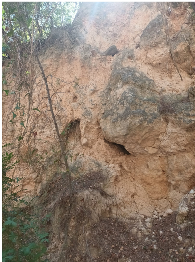
Imatge 8. Despreniments de talussos en zona de les embocadures
