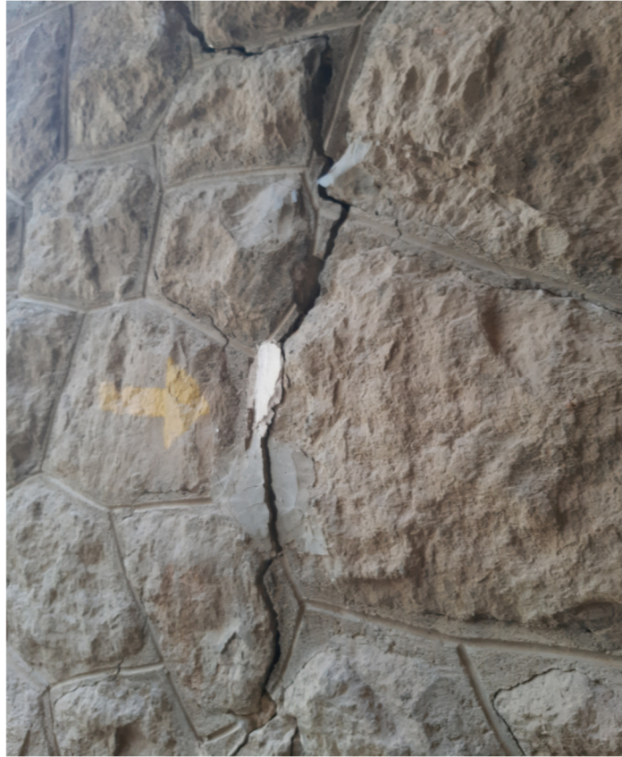
Imatge 21. Junta oberta, reparada anteriorment
