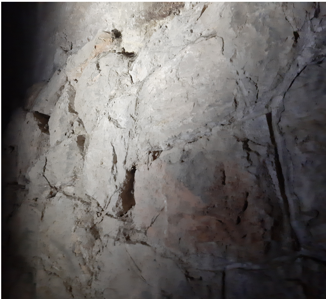
Imatge 11 i 12. Junes disgregades i bombaments de mur de carreu
