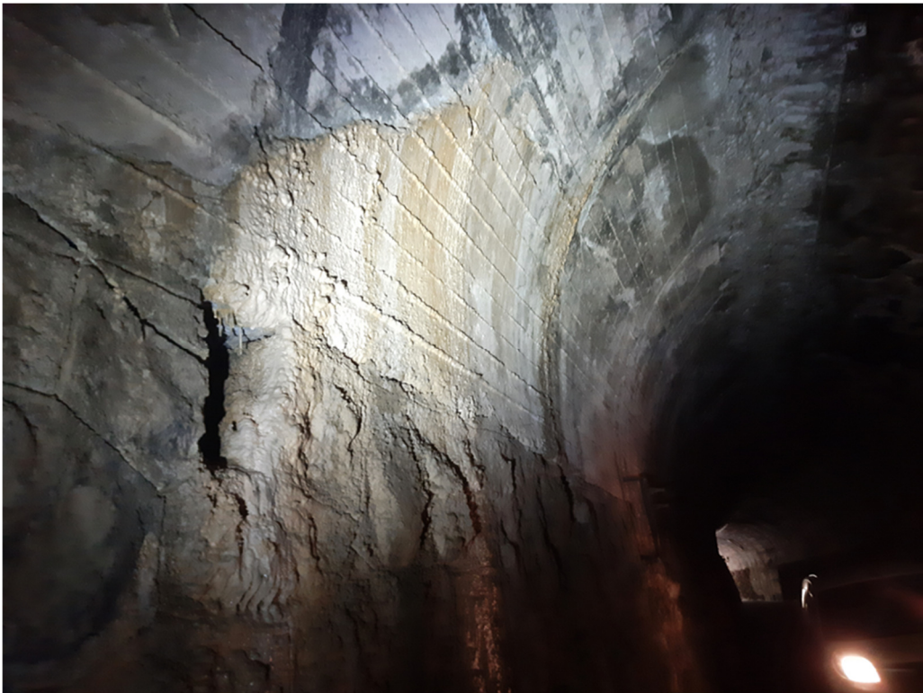
Imatge 17. Regalims i precipitacions de calç en zona propera a drenatge
