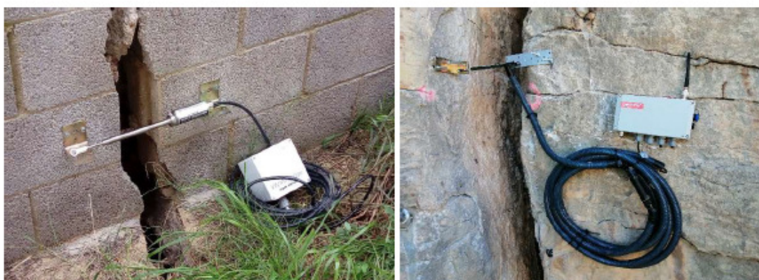
Figura 7. Exemple d'auscultació mitjançant instrumentació connectada a data logger manual o connexió remota
