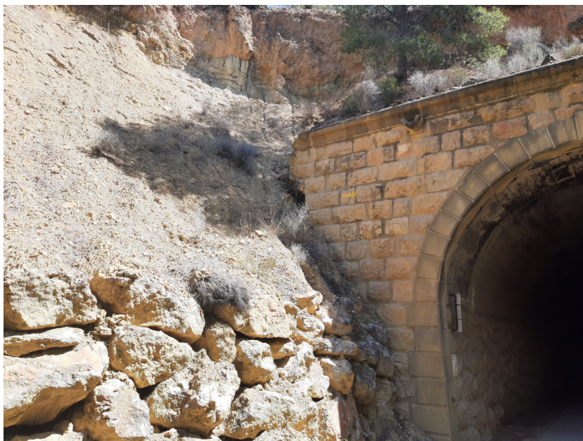
Imatge 9. Boca Sud de túnel H. Pèrdua de recolzament
