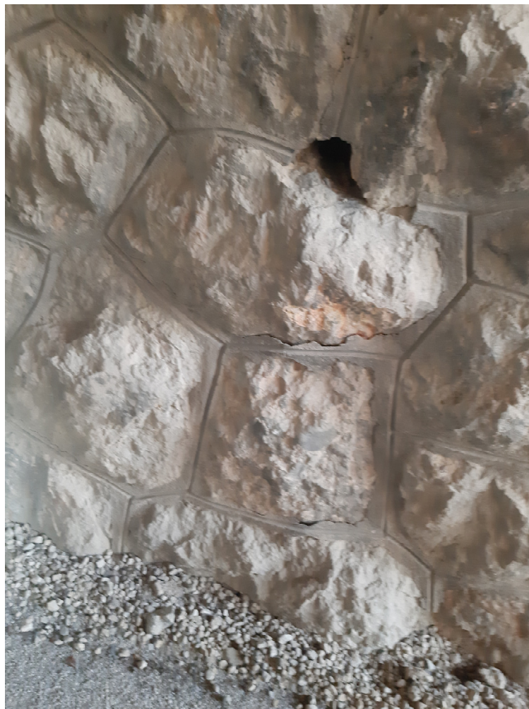
Imatge 13 i 14. Junes disgregades i trencament per junta
