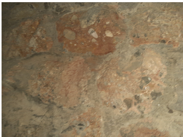
Imatge 18. Desgast de carreus
