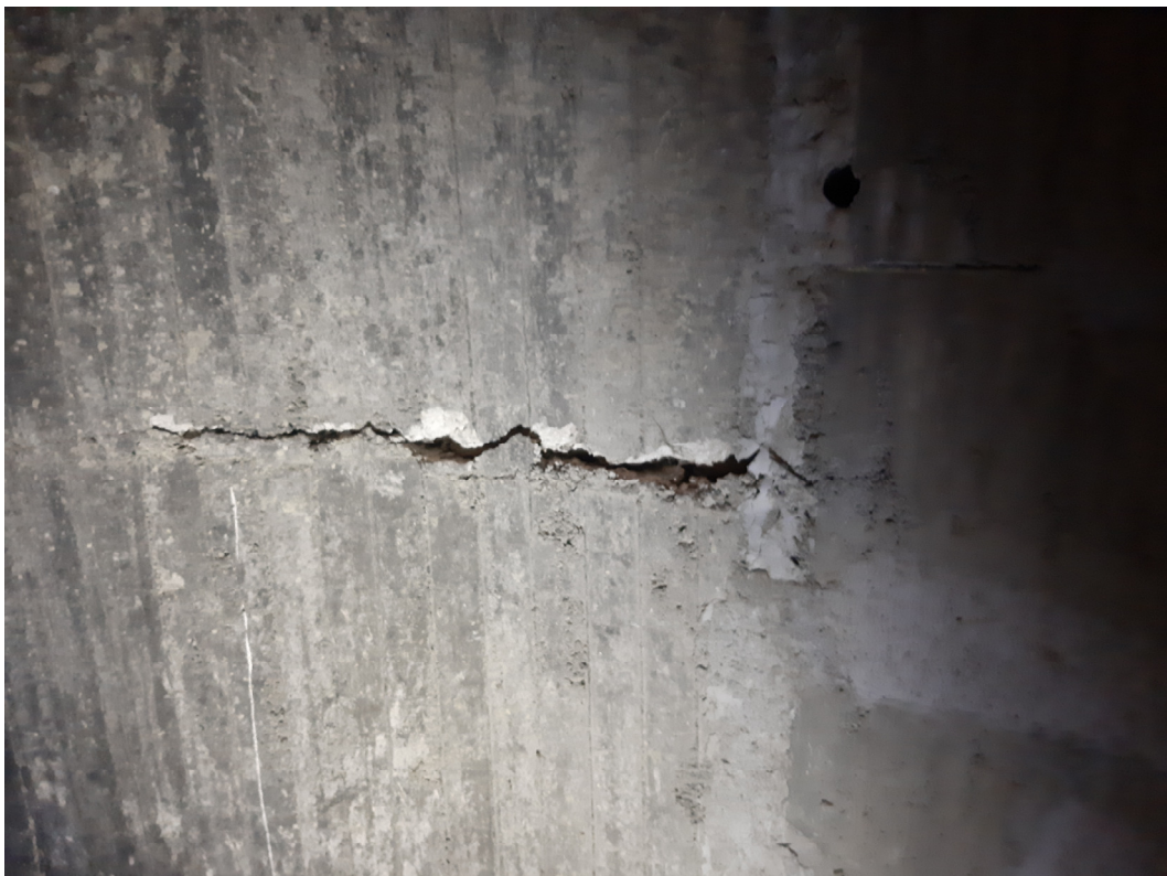
Imatge 18. Esquerdes al formigó de la volta
