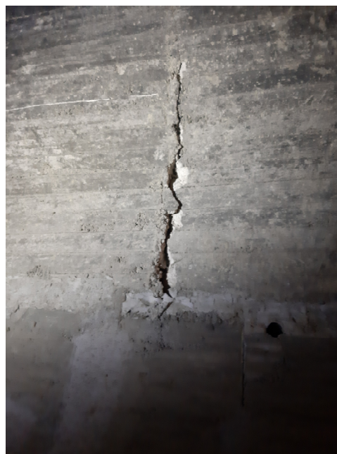
Imatge 21. Esquerdes al formigó de la volta
