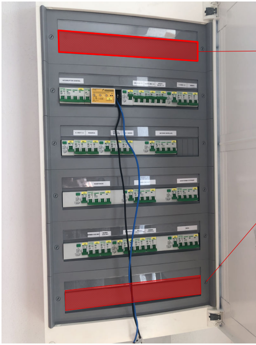
CUADRO GENERAL DE MANDO Y PROTECCIÓN
