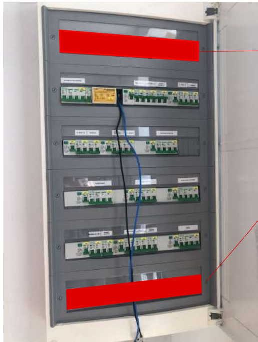
CUADRO GENERAL DE MANDO Y PROTECCIÓN
