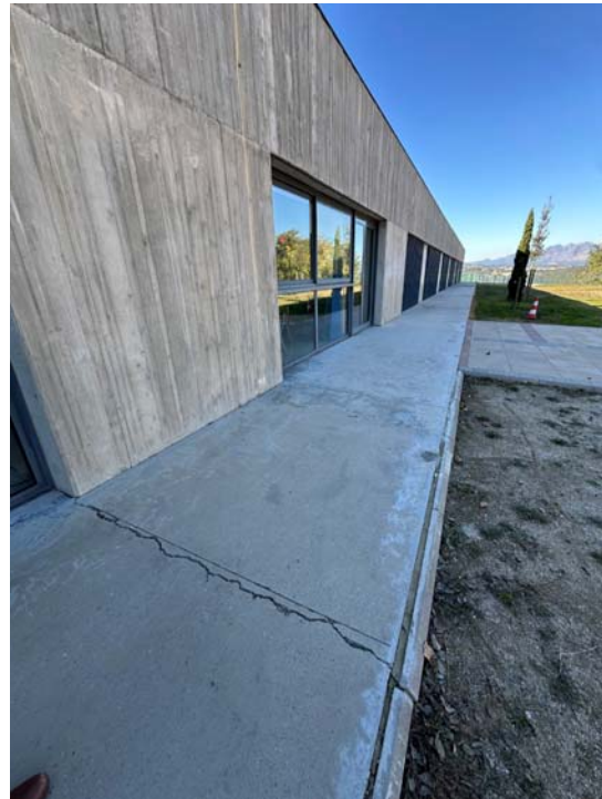
Imatge de l'estat actual de les fissures en paviment
