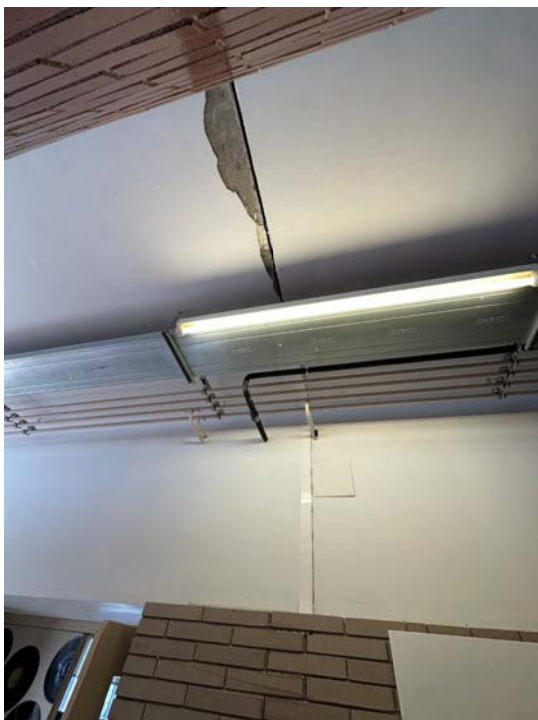
Imatge de l'estat actual de la junta de dilatació en façana
