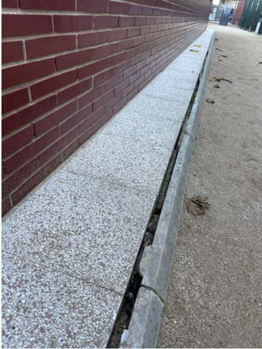
Imatge de l'estat actual de la vorada del paviment exterior
