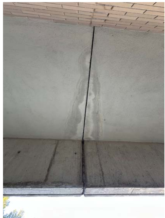
Imatge de l'estat actual de la junta de dilatació en façana
