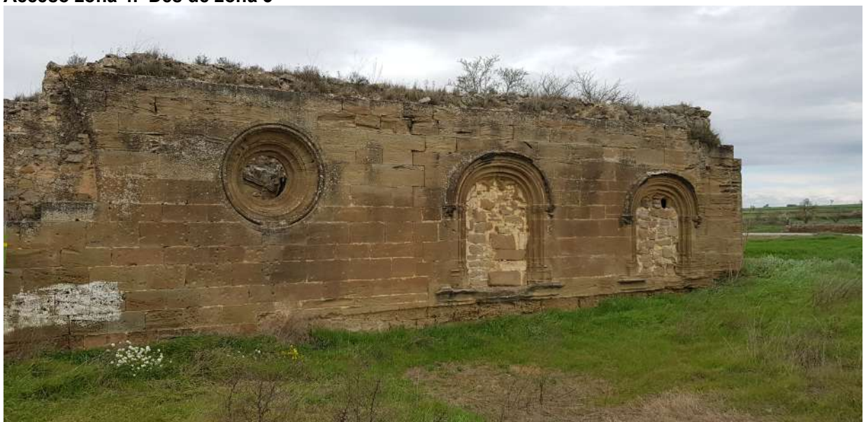
Fachada principal, parte derecha, ventanales tapiados
