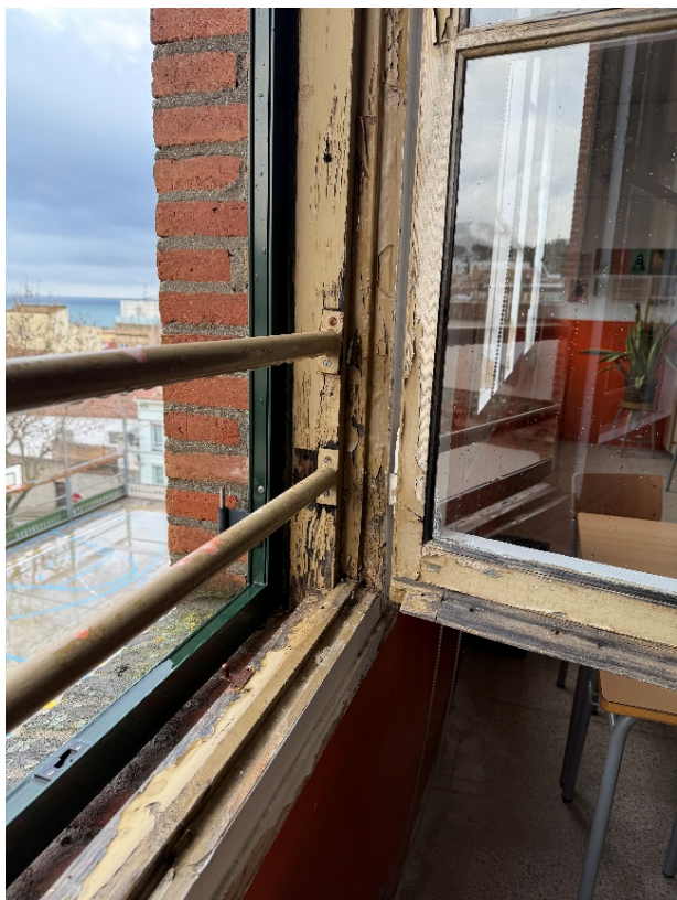
Estat deteriorat fusteries actuals de fusta.
