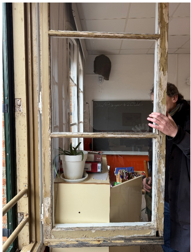
Estat deteriorat fusteries actuals de fusta.
