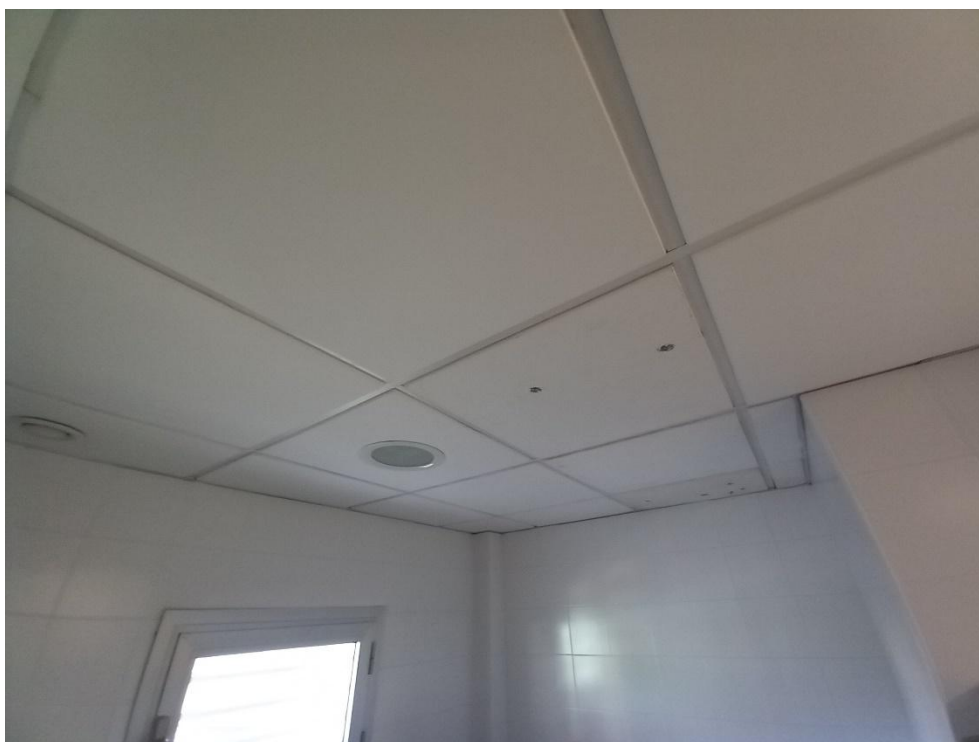
Foto 4: Filtracions als banys
