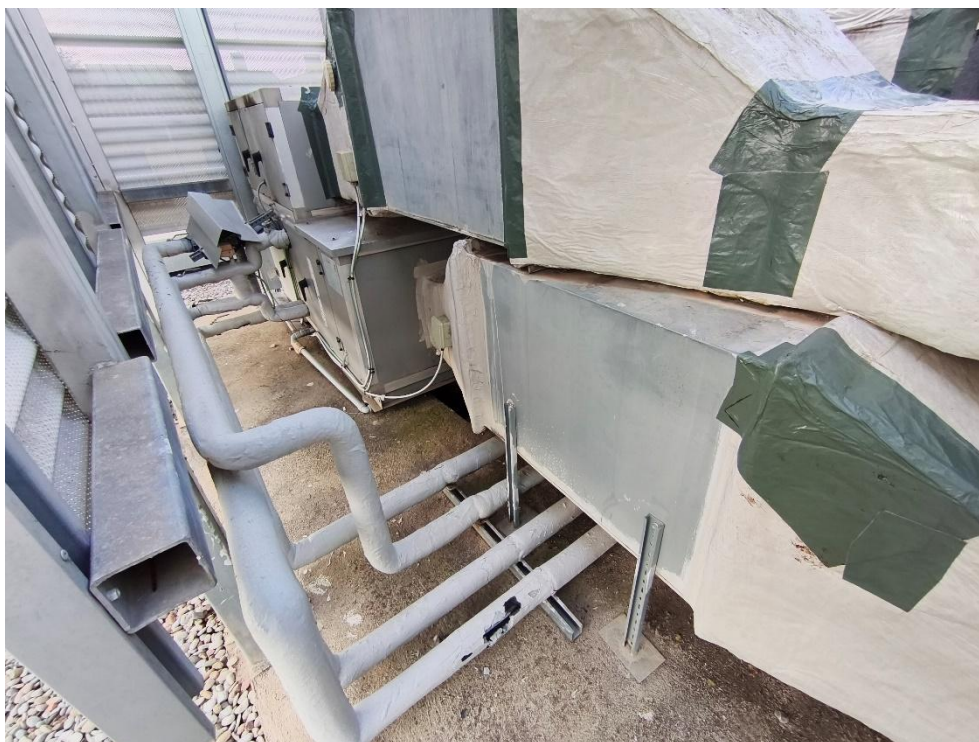
Foto 8: Conductes d'instal·lació de clima deteriorats i reparats
