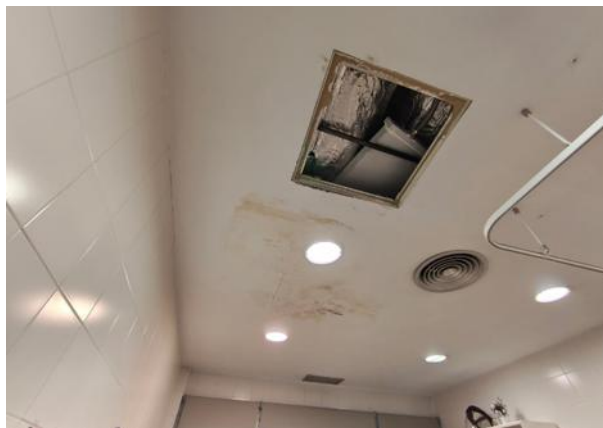
Imatge 7: Filtracions a la consulta annexa al lavabo.
