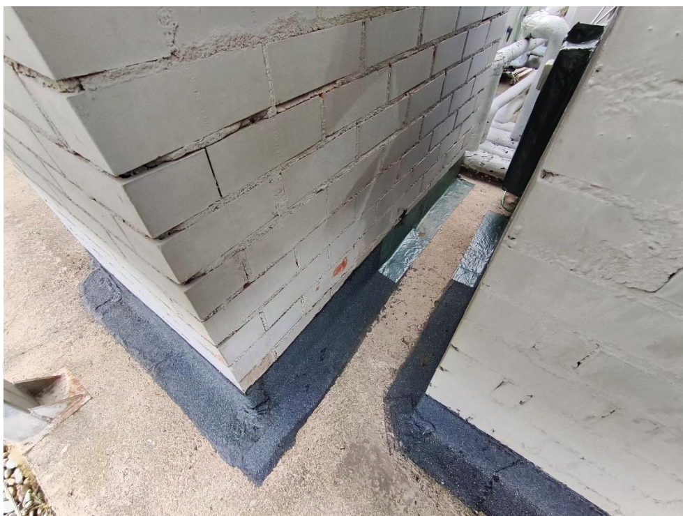
Foto 9: Construccions i Conductes d'instal·lació de clima deteriorats i reparats
