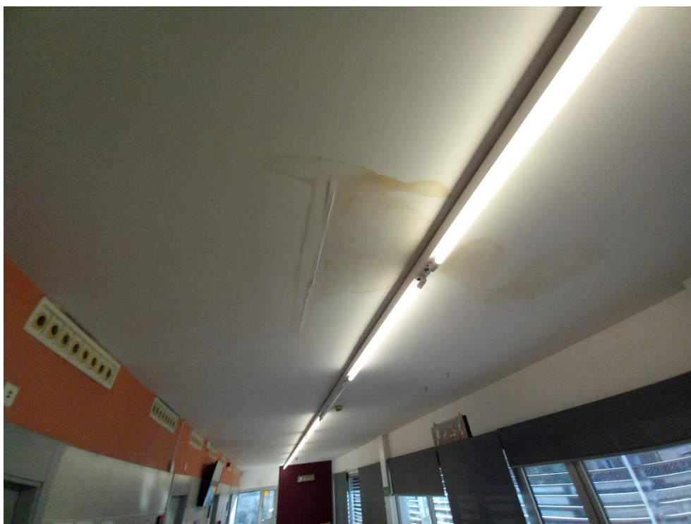
Foto 2: Filtracions al sostre del passadís sota coberta
