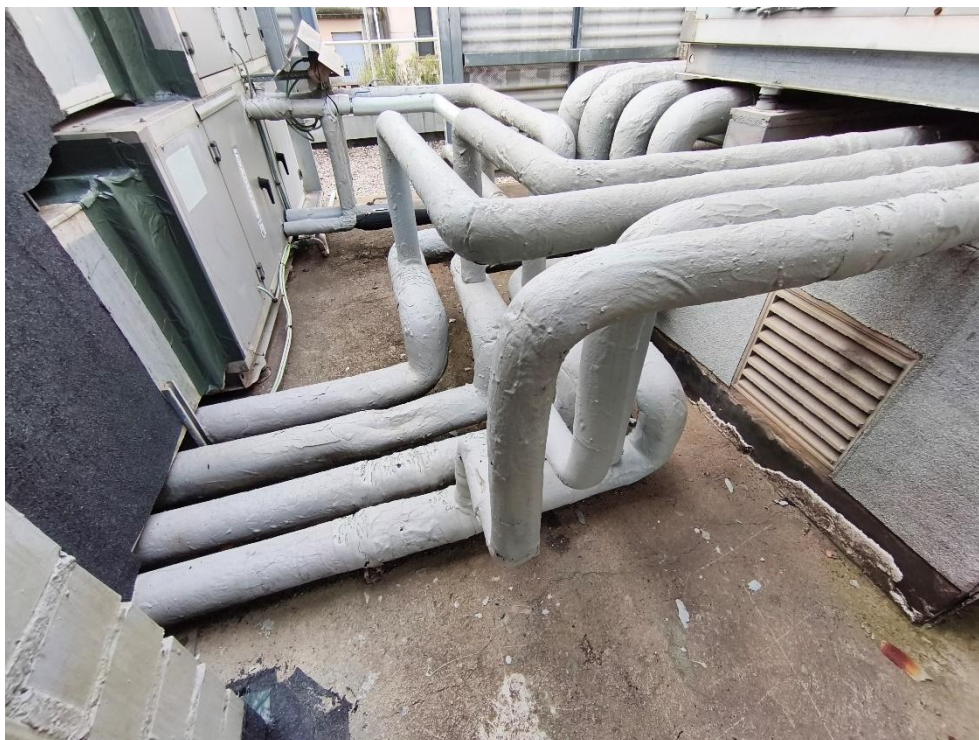
Foto 7: Conductes d'instal·lació de clima deteriorats
