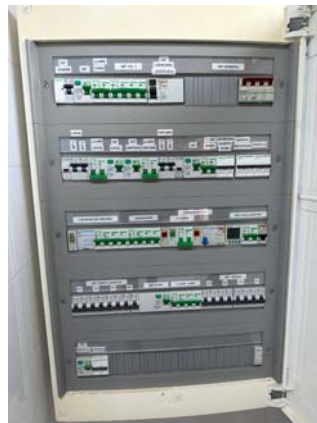
Imatge del quadre existent de protecció de la instal·lació
