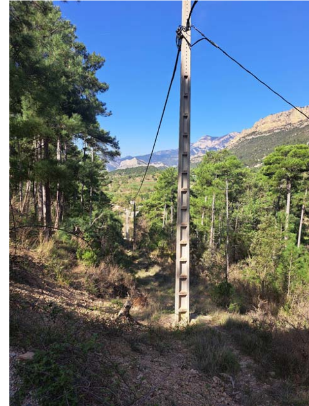
11 Línia elèctrica a la zona de Ca l'Espinal, per connexió de la nova escomesa elèctrica de les instal·lacions del nou dipòsit
