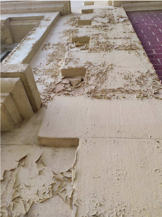
Imatge d'estuc i pedra artificial amb pintura deteriorada.
