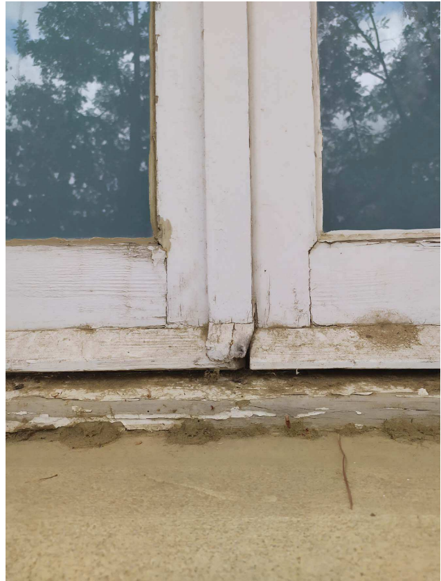
Imatge de la part baixa d'una fusteria exterior deteriorada.
