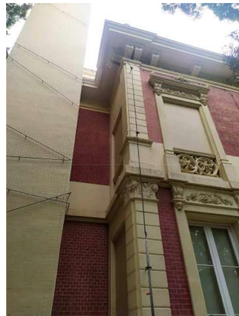
FOTOGRAFIA 10 BALCONERA TAPIADA FAÇANA PRINCIPAL NORD-EST
