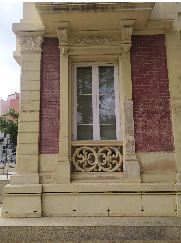
Imatge actual de façana amb deteriorament d'estuc i antigrafiti i pedra artificial.
