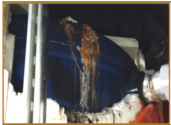
Figura 10: Fotografia de la presència d'òxids i calç – febrer de 2025.
