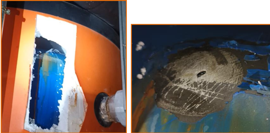
Figura 6: Fotografies de les fuites del dipòsit acumulador
