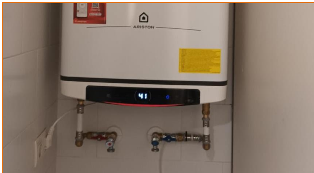
Figura 20: Fotografia del detall de la instal·lació del termo amb T, claus d'esquadra, claus de pas de llautó i vàlvules d'esfera de papallona
