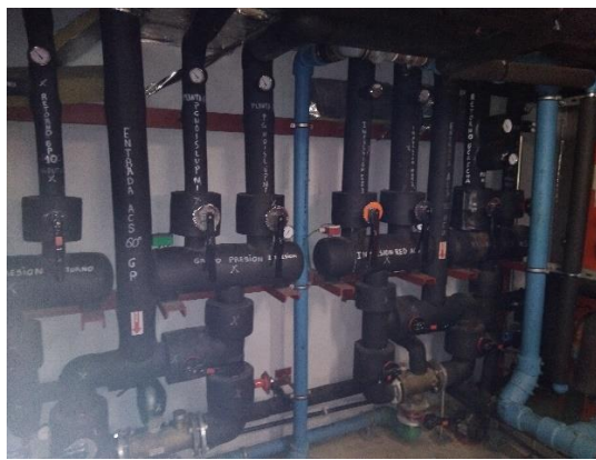
Imatge de col·lectors distribució ACS
