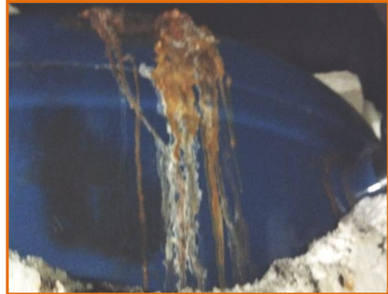
Figura 9: Fotografia de la presència d'òxids i calç – febrer de 2025.
