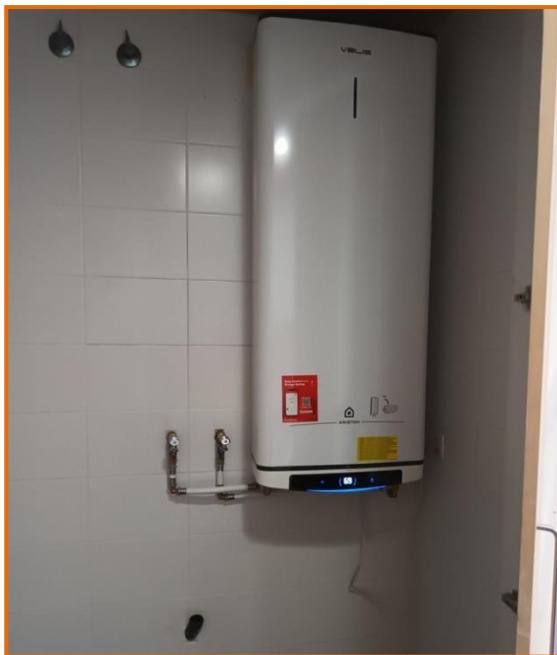
Figura 15: Fotografia de termo instal·lat
