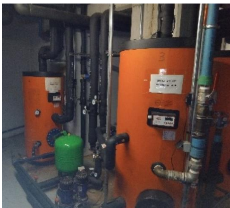
Imatge de dipòsits acumuladors ACS
