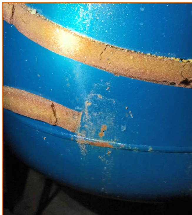
Figura 5: Fotografia del dipòsit de 300L. amb la fuga.
