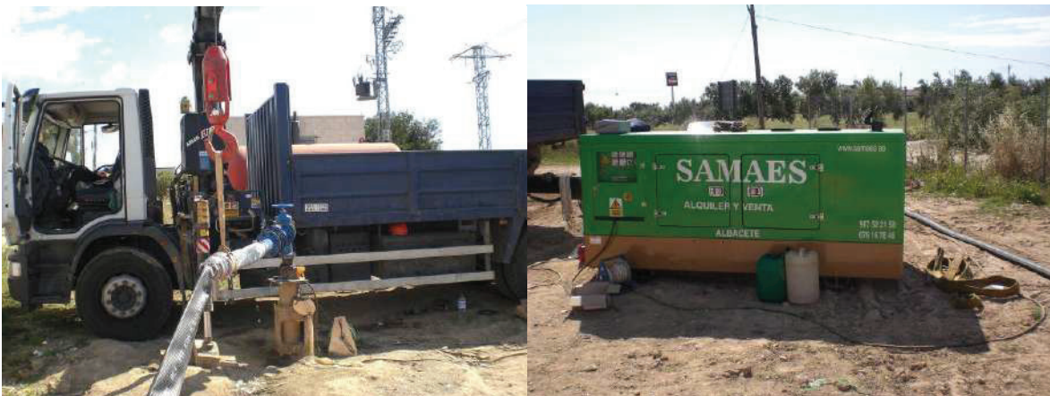
Fotografía nº 2.-Detalle del grupo de aforo
