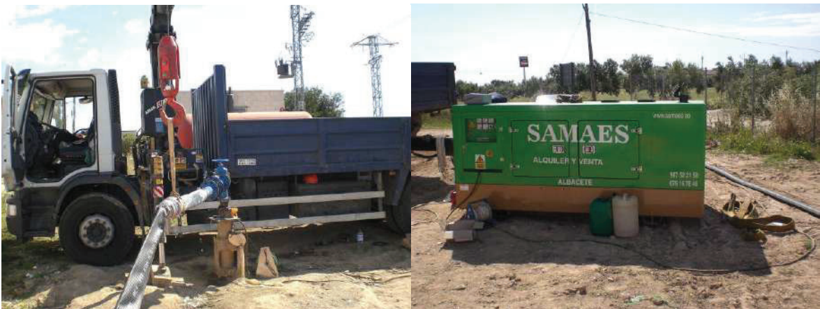
Fotografía nº 2.-Detalle del grupo de aforo
