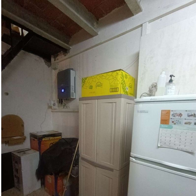
Fig. 4 Vista detall ubicació inversor actual a la paret interior de l'edifici. El nou inversor s'ubicarà en aquesta mateixa sala en una ubicació semblant a l'actual.
