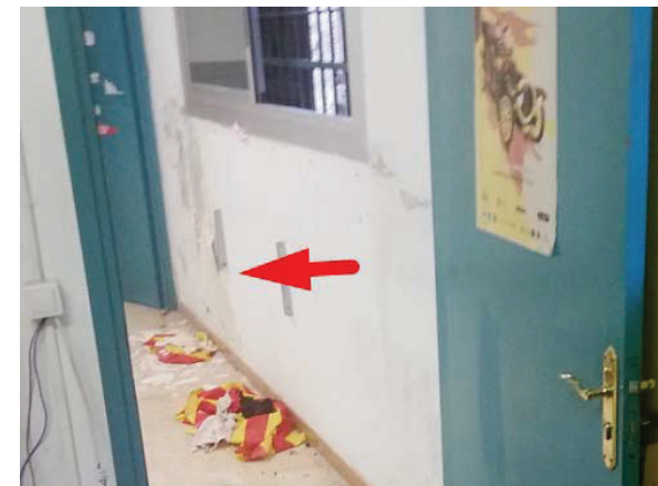
In 16: Vista d'una taca d'humitat en base del mur.
