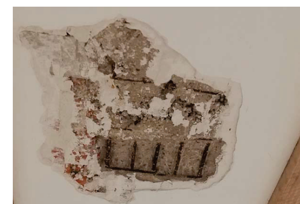
In 25: Cala de jàssera en la qual es verifica que hi ha corrosió de les armadures.
