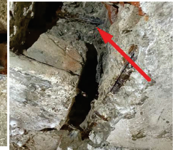
In 14: Barres detectades per sobre de la bigueta prefabricada
