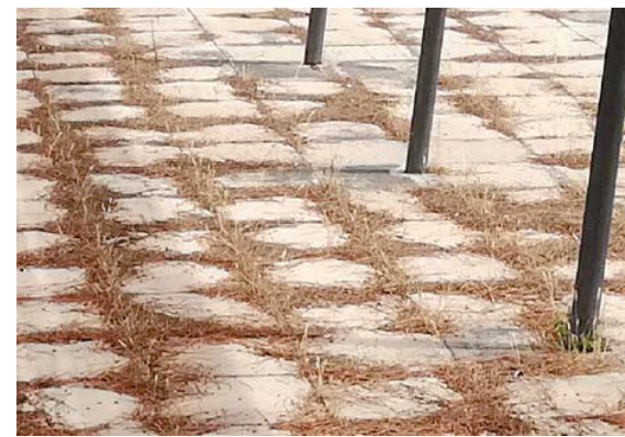
In 22: Acumulació de fullaraca i vegetació entre les juntes del sòl tècnic de la terrassa.
