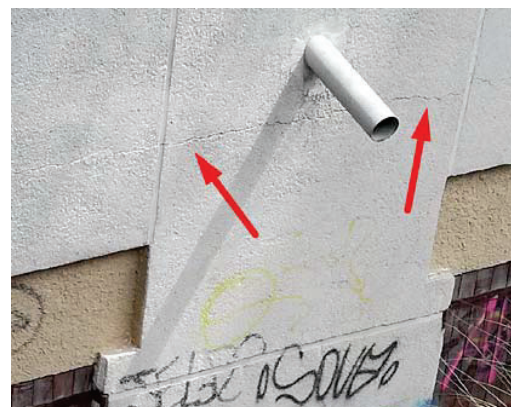
In 30: Esquerde en façana amb mur de càrrega. Coincideix amb el punt de recolzament del forjat.
