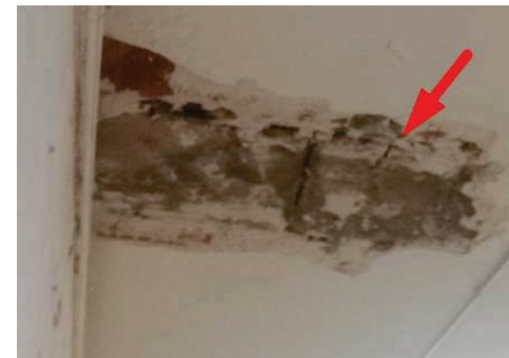
In 23: Armadures amb corrosió i recobriment escàs
