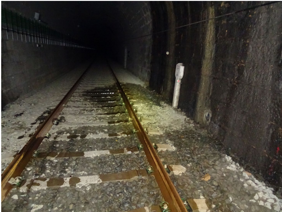
Figura 2. Imatge dels degoteigs que afecten als rails i travesses de les vies.
