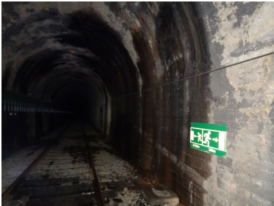
Figura 1. Imatge de les humitats i regalims del túnel.
