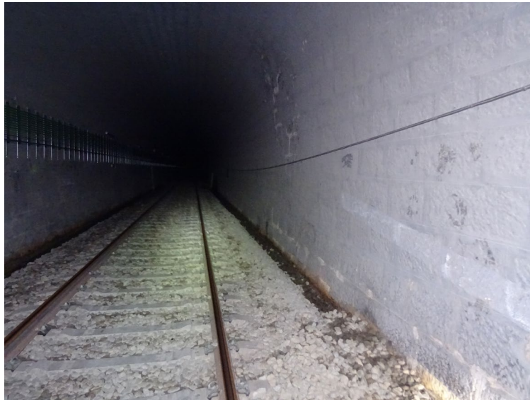
Figura 8. Vista de la situació d'una reixa de captació d'aigua.
