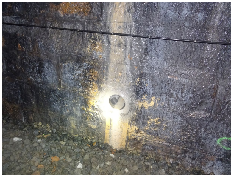
Figura 9. Imatge d'un dels drenatges funcional.
