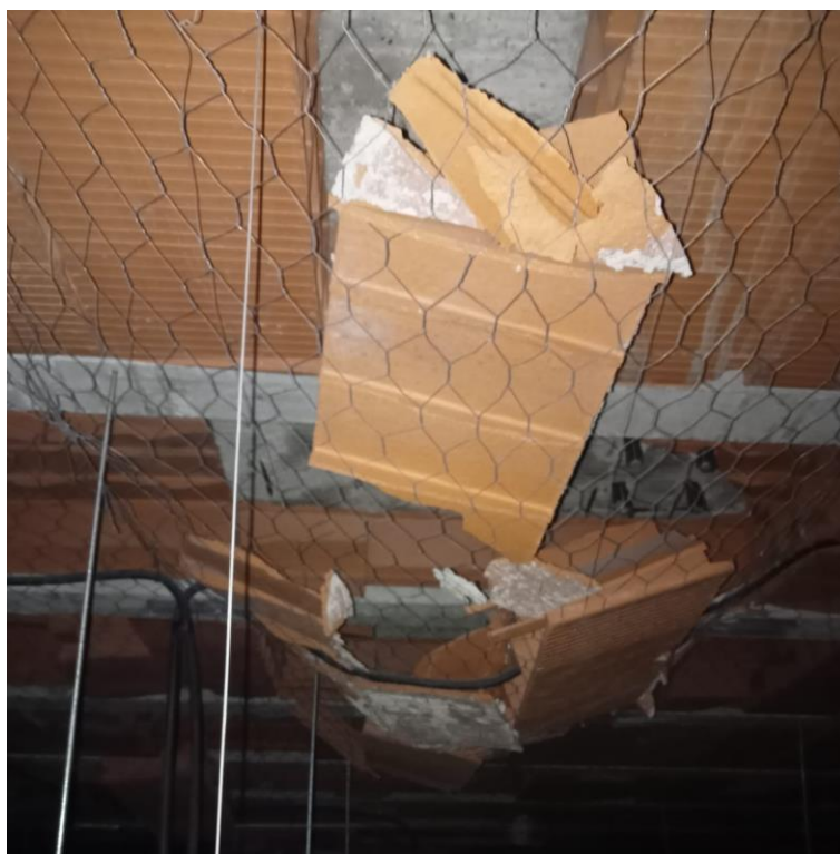
Estat revoltans abans col·locació xarxa protectora (2)
