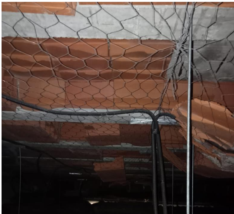
Estat revoltans abans col·locació xarxa protectora (1)
