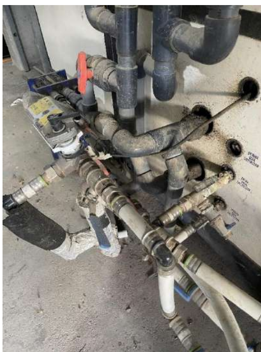
Canonades actuals de connexió amb les bateries de calor i aprofitament de calor per la piscina, de la deshumectadora
