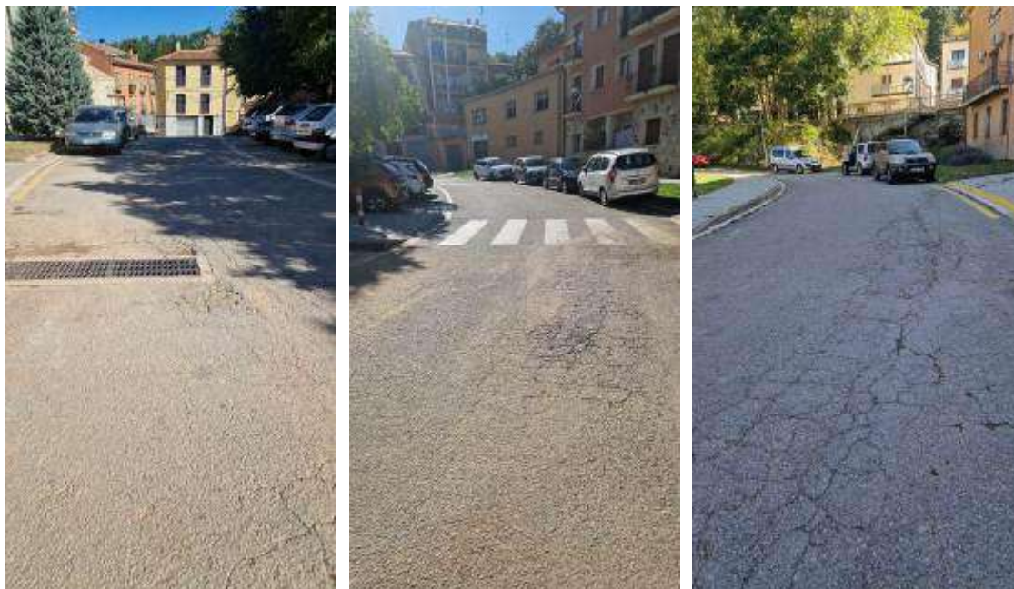
Imatges diverses del ferm malmès de la Plaça Guillerries.
