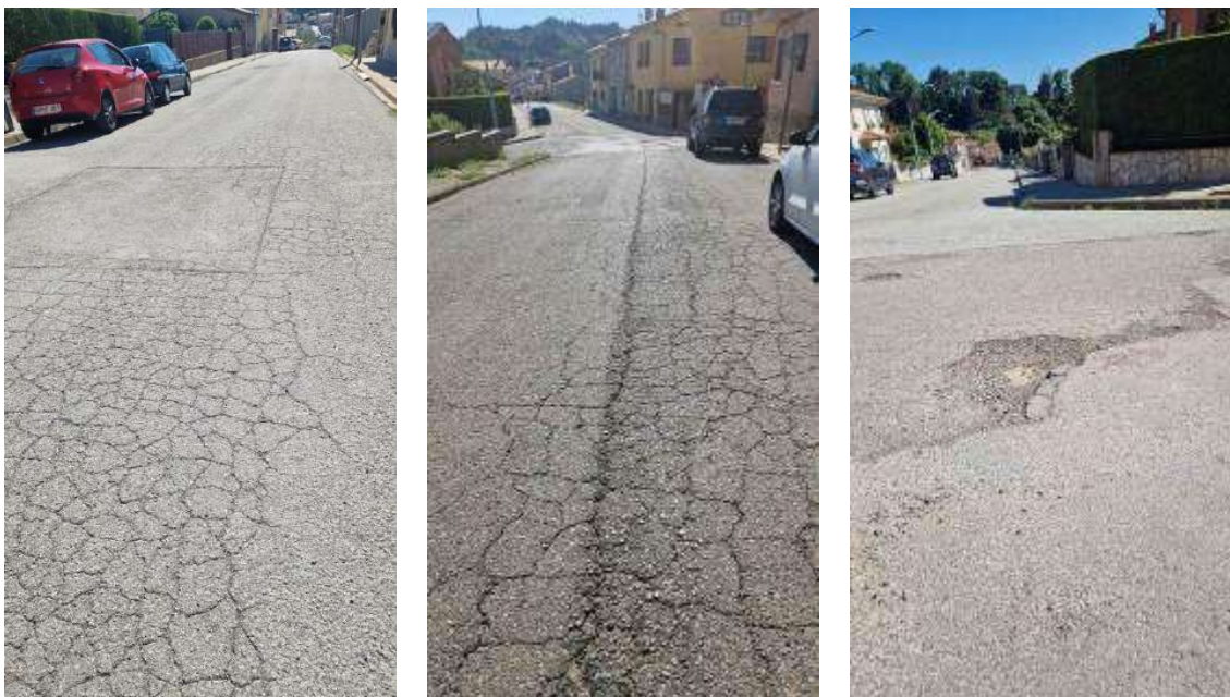
Imatges diverses del ferm malmès a la cruïlla entre els carrers Santa Margarida i Pintor Vayreda.
