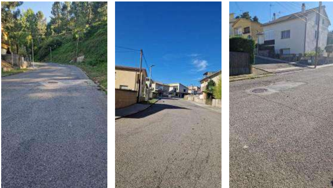
Imatges diverses del ferm malmès en el carrer de Francesc Culí.
