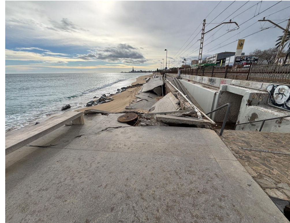
Imatge 1.- Vista del tram on es va produir la ruptura global del vial
