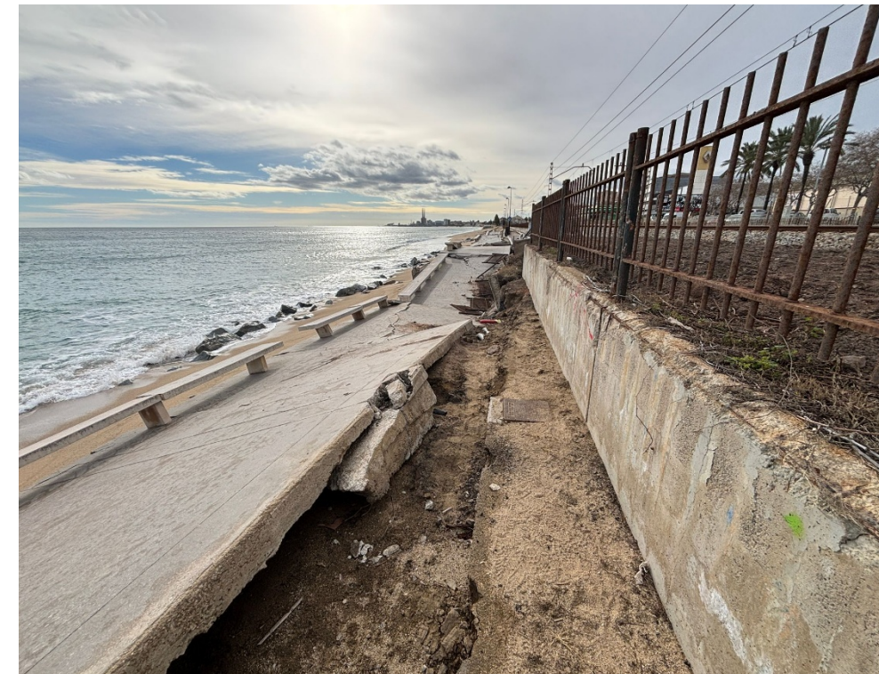
Imatge 2.- Vista del tram on es va produir la ruptura global del vial
