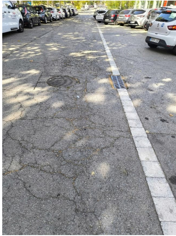
Il·lustració 17: Estat de la calçada del lateral costat mar de la Ctra. de la Santa Creu de Calafell entre el carrer de la Riera Roja i el carrer d'Alacant. Mirant direcció Sud-Oest.
