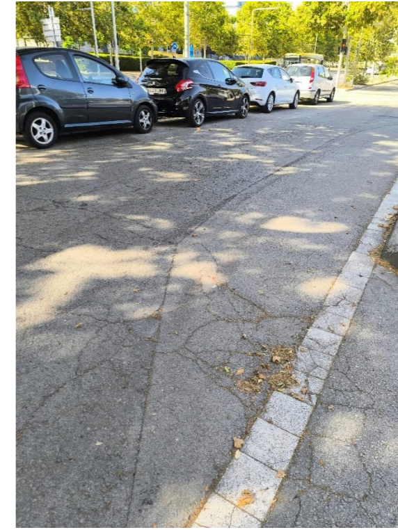
Il·lustració 19: Estat de la calçada del lateral costat mar de la Ctra. de la Santa Creu de Calafell a l'alçada del carrer d'Alacant. Mirant direcció Nord-Est.
