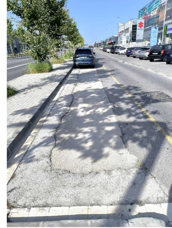
Il·lustració 7: Estat de la zona d'aparcament de l'esquerra del lateral costat mar de la Ctra. de la Santa Creu de Calafell a l'alçada del carrer Dr. Josep Castells. Mirant direcció Nord-Est.
