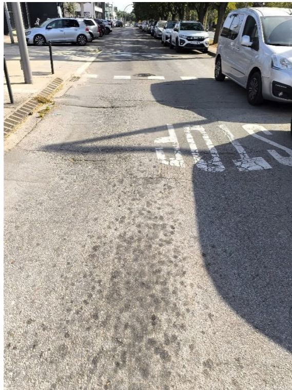
Il·lustració 22: Estat de la calçada del lateral costat mar de la Ctra. de la Santa Creu de Calafell a l'alçada del carrer d'Osca. Mirant direcció Sud-Oest.
