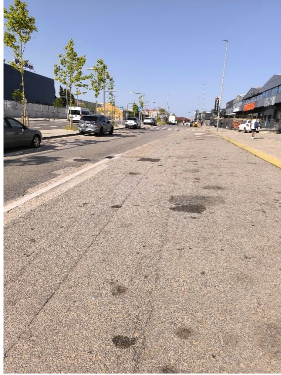
Il·lustració 9: Estat de la calçada al lateral costat mar de la Ctra. de la Santa Creu de Calafell entre el carrer Dr. Josep Castells i el carrer de la Riera del Fonollar. Mirant direcció Nord-Est.
