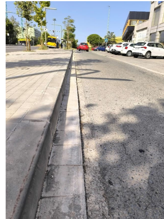
Il·lustració 16: Estat de la vorada i rigola del lateral costat mar de la Ctra. de la Santa Creu de Calafell a l'alçada del carrer de la Riera Roja. Mirant direcció Nord-Est.
