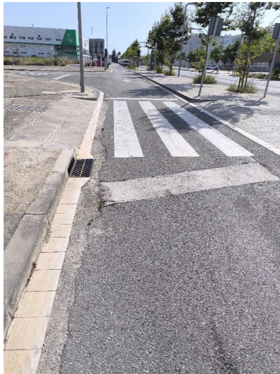
Il·lustració 6: Estat del pas de zebra al lateral costat mar de la Ctra. de la Santa Creu de Calafell a l'alçada del carrer Dr. Josep Castells. Mirant direcció Sud-Oest.
