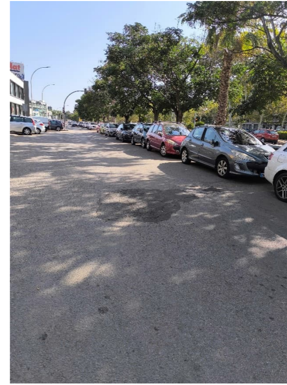
Il·lustració 23: Estat de la calçada del lateral costat mar de la Ctra. de la Santa Creu de Calafell en la seva connexió amb la C-245. Mirant direcció Nord-Est.
