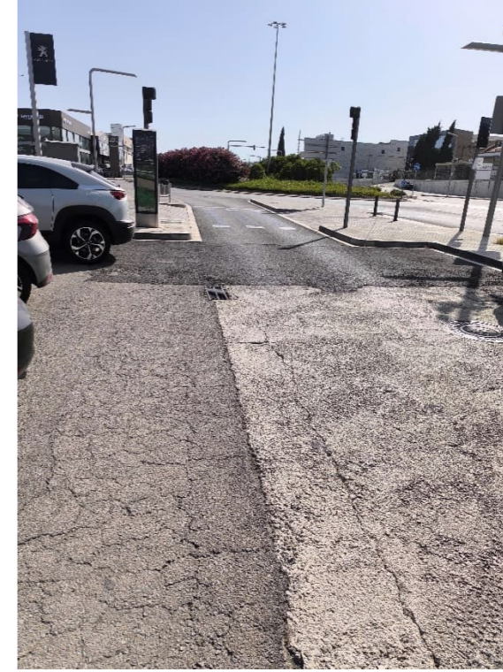
Il·lustració 11: Estat de la calçada al lateral costat mar de la Ctra. de la Santa Creu de Calafell a l'alçada del carrer de la Riera del Fonollar. Mirant direcció Sud-Oest.
