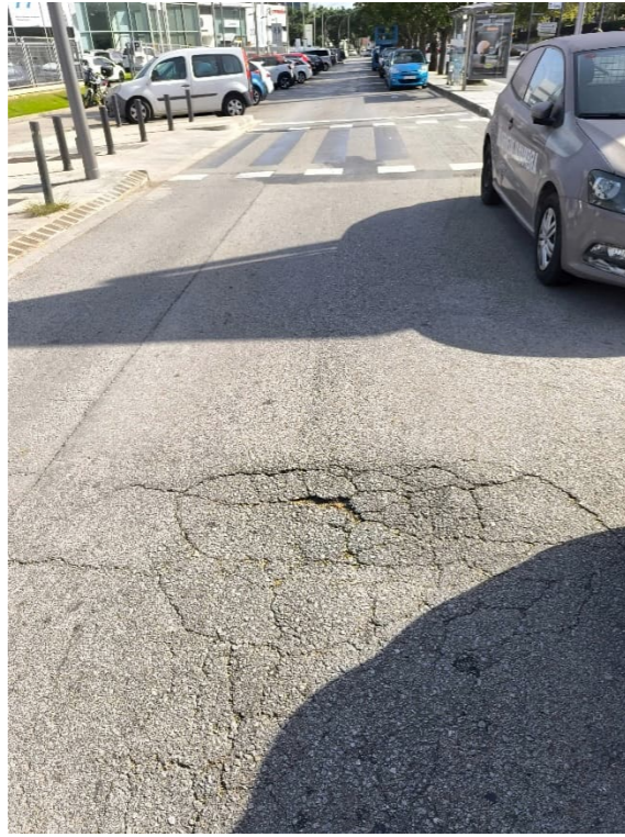
Il·lustració 21: Estat de la calçada del lateral costat mar de la Ctra. de la Santa Creu de Calafell a l'alçada del carrer de les Salines. Mirant direcció Sud-Oest.
