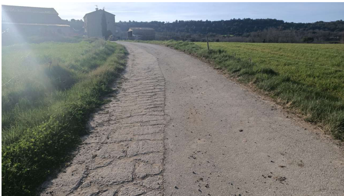
Tram 4 Zona final camí (F10)
