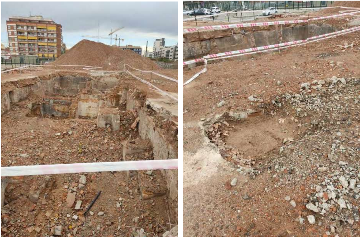
Il·lustració 4. A la izquierda fotografía del antiguo sótano y a la derecha fotografía del picado de hormigón de la losa existente
