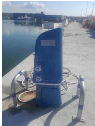
Fotos 1. Exemple de torreta de prova telegestionada instal·lada
