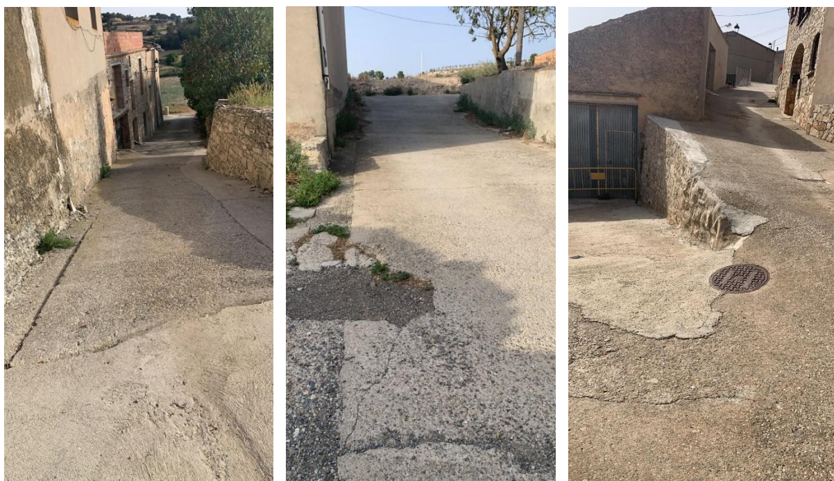
Carrers amb paviment de formigó que presenten esquerdes prèvies a l'execució de les obres.
