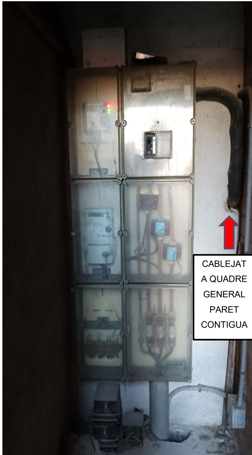
Imatge 7: Escomesa elèctrica TMF10 existent
