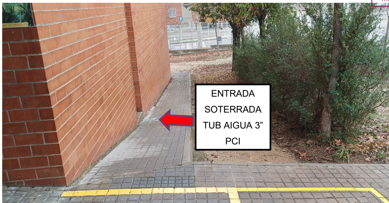
Imatge 9: Entrada actual instal·lació tub aigua 3" contra incendis principal BIES
