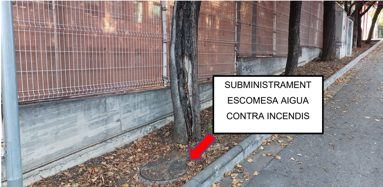
Imatge 1: Perico registrable subministrament aigua contra incendis a l'edifici per Carrer de Pau Vila
