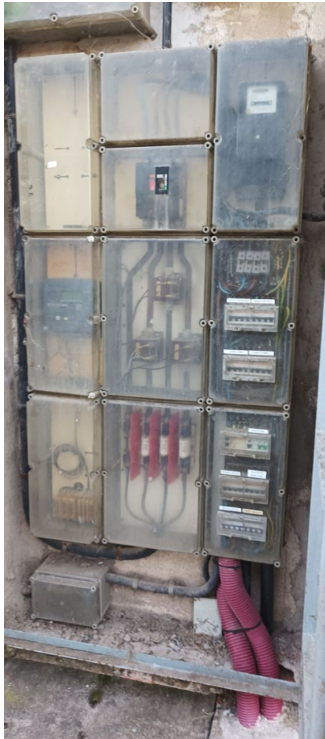
Imatge 7: Escomesa elèctrica existent
