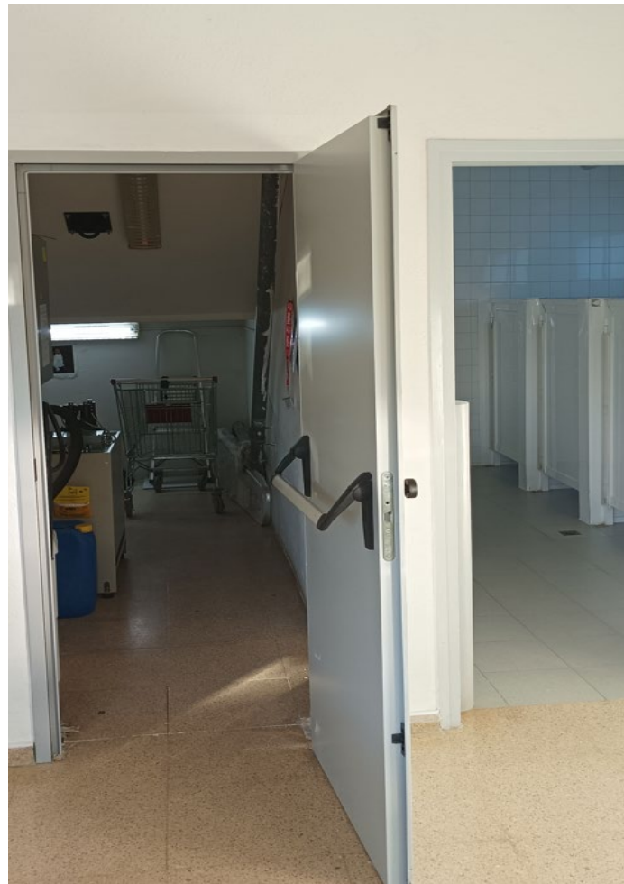
Imatge 8: Entrada actual instal·lació aigua contra incendis per anul·lar que ve des de exterior
