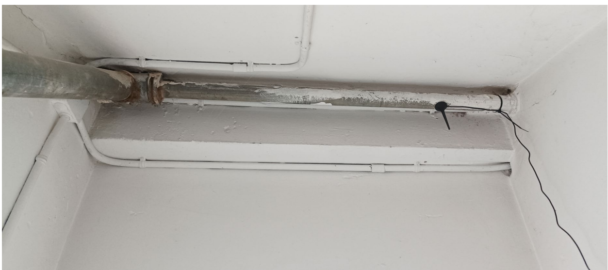
Imatge 9: Entrada actual instal·lació aigua contra incendis per anul·lar que va a ramal principal BIES
