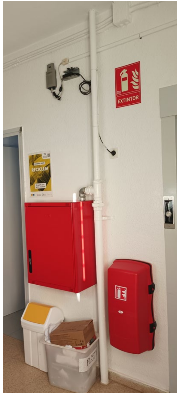
Imatge 12: BIE connectat en planta primera en ramal vertical
