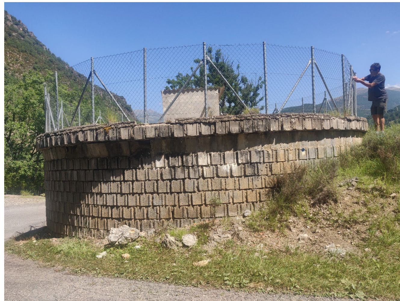
Il·lustració 4. Dipòsit vist des de l'exterior, s'aprecia un grau d'inclinació notable en relació al plànol horitzontal.
