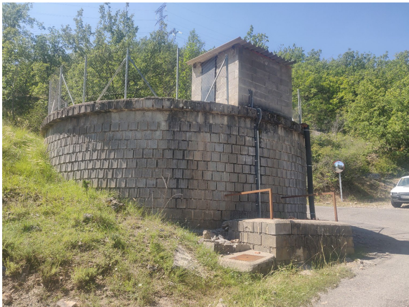
Il·lustració 1. Vista del dipòsit des del camí de Buira, orientació oest. Mostra el dipòsit amb el tancament perimetral, la caseta de cloració, les canonades de sortida.
