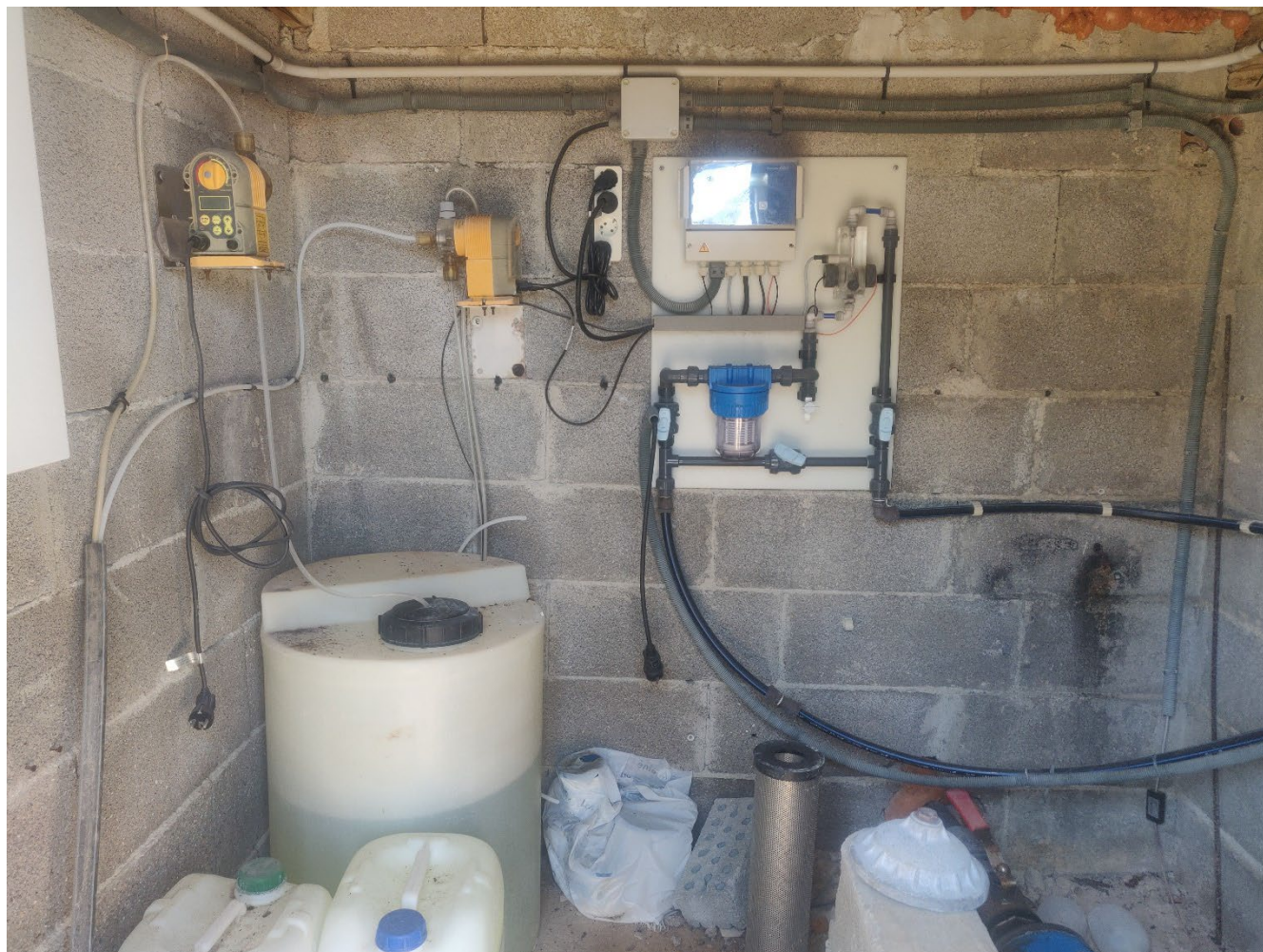
Il·lustració 7. Interior de la caseta de cloració
