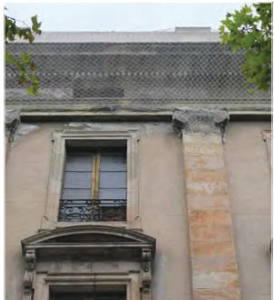
Xarxa de protecció sobre la cornisa de coronament. Font: GAA 03/08/2021
