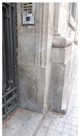
Oxidació de reixes de forja de la porta d'accés per restes d'orina. Font: GAA 03/08/2021
