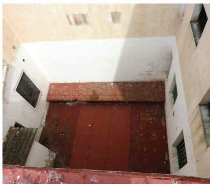
Terrat del pati interior. Brutícia generalitzada i degradació del paviment. Volums disconformes. Font: GAA 04/08/2021
