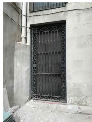
Oxidació de les reixes de forja de protecció de les obertures de façana. Font: GAA 03/08/2021
