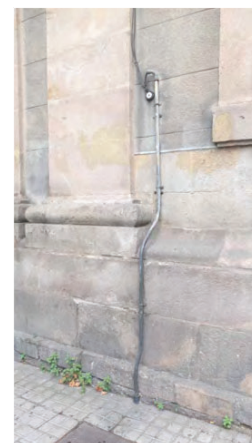
Instal·lacions obsoletes adossades a la façana. Font: GAA 04/08/2021
