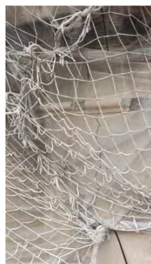
Esquerdes en el parament del capcer del rellotge. Font: GAA 04/08/2021
