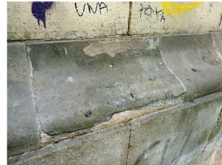
Reparacions de juntes i pèrdua d'elements amb morter de ciment pòrtland. Graffitis. Font: GAA 03/08/2021
