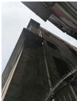
Xarxa de protecció en cornises de planta primera i de coronament de l'edifici. Font: GAA 03/08/2021
