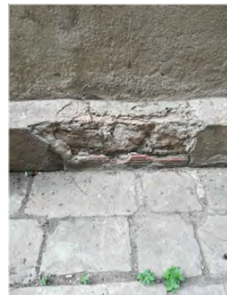
Pèrdua del revestiment de la soclada. Font: GAA 04/08/2021
