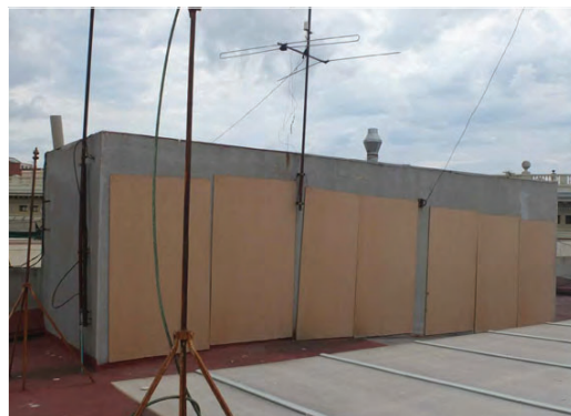
Volums disconformes sobre coberta (trasters). Instal·lacions obsoletes. Font: GAA 04/08/2021
