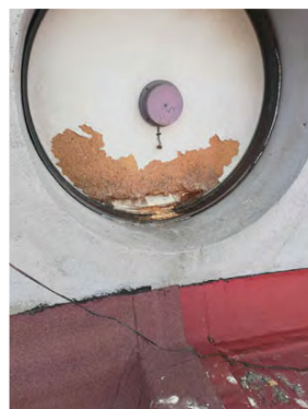
Element de protecció del rellotge en mal estat de conservació. Font: GAA 04/08/2021
