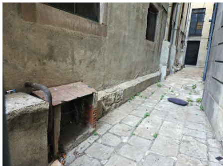
Presència de vegetació i acumulació de brutícia en el passatge intern. Font: GAA 03/08/2021
