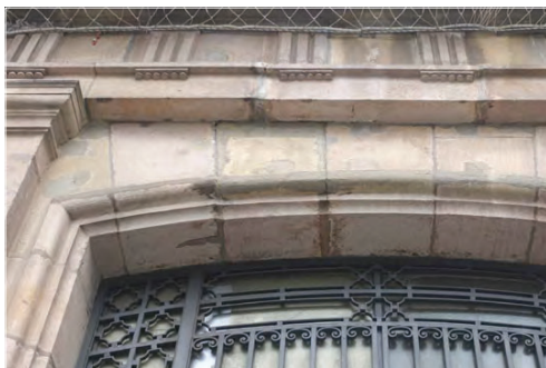
Reparació de juntes entre carreus amb materials disconformes (morter de ciment pòrtland). Font: GAA 04/08/2021
