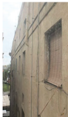
Obertures disconformes amb el ritme de la resta de façanes. Font: GAA 30/08/2021
