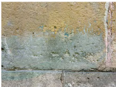
Ús de diferents materials disconformes duts a terme en diferents reparacions dels revestiments de les façanes. Font: GAA 03/08/2021
