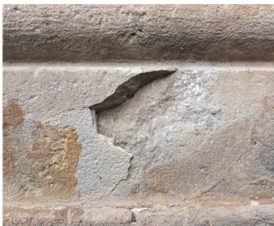
Pèrdua de secció de la pedra de Montjuïc del basament de l'edifici. Reparacions amb materials disconformes. Font: GAA 04/08/2021
