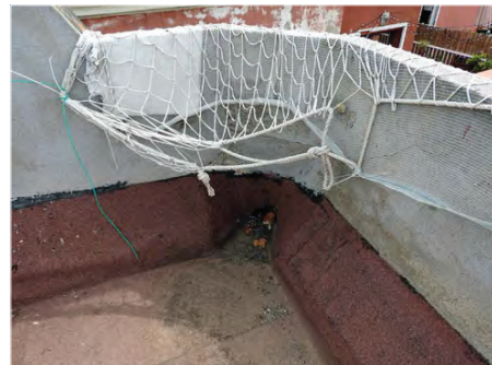
Punts d'evacuació d'aigües pluvials de la coberta obstruïts de brutícia. Font: GAA 04/08/2021
