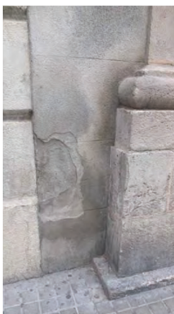
Pèrdua de l'arrebossat amb morter de ciment pòrtland. Font: GAA 03/08/2021
