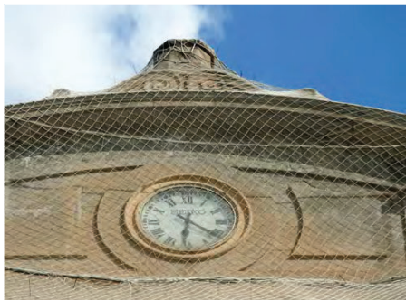
Xarxa de protecció en el capcer del rellotge per possibles desprendiments de materials. Font: GAA 03/08/2021
