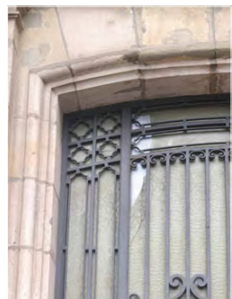
Vidres trencats de la portalada principal. Font: GAA 04/08/2021
