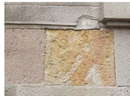
Desprendiment del revestiment de ciment pòrtland. A sota es pot observar l'arrebossat original de morter de calç. Font: GAA 04/08/2021
