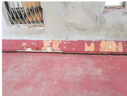
Paraments verticals de badalot d'escala i minvell perimetral ceràmic en mal estat de conservació. Font: GAA 04/08/2021
