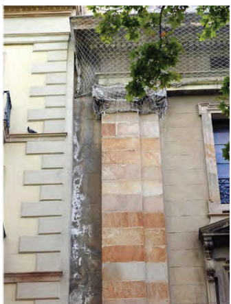
Concentració de sals en forma d'eflorescències en els paraments verticals. Font: GAA 03/08/2021
