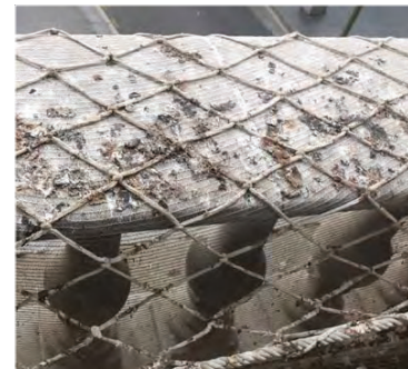
Acumulació de brutícia i excrements d'aus sobre les baranes de balustres de planta primera. Font: GAA 04/08/2021
