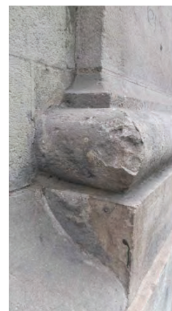
Erosió i pèrdua de secció del basament de pedra dels pilars. Font: GAA 03/08/2021
