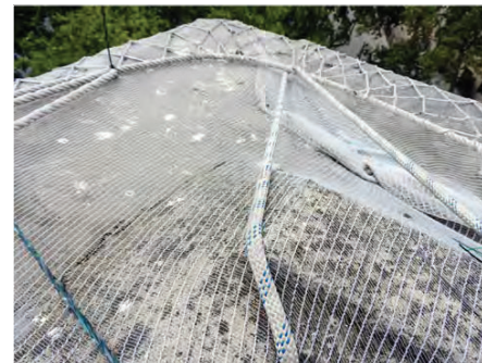
Xarxa de protecció per evitar desprendiments dels elements que conformen la barana de coberta. Font: GAA 03/08/2021
