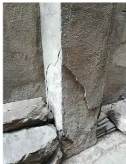
Pilars ceràmics de protecció de baixants. Font: GAA 04/08/2021
