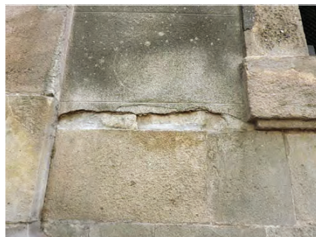
Despreniment del revestiment de ciment pòrtland. A sota es pot observar l'arrebossat original de morter de calç. Font: GAA 03/08/2021
