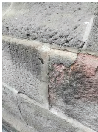
Reparació de juntes entre carreus amb materials disconformes (morter de ciment pòrtland). Font: GAA 04/08/2021
