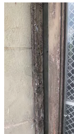
Fusteries de fusta de planta primera en mal estat. Font: GAA 04/08/2021
