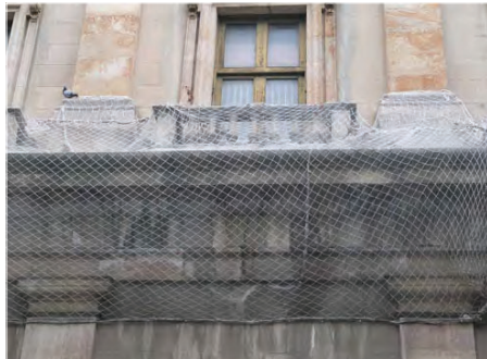
Xarxa de protecció de balcons de balustres i cornises de planta primera. Font: GAA 03/08/2021
