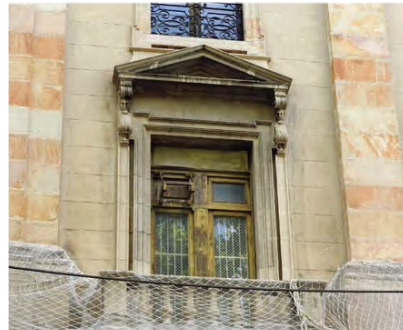
Fusteries de balconeres de planta primera i segona en mal estat de conservació. Font: GAA 03/08/2021
