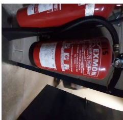
Imatge 4. Etiqueta revisió Extintor
