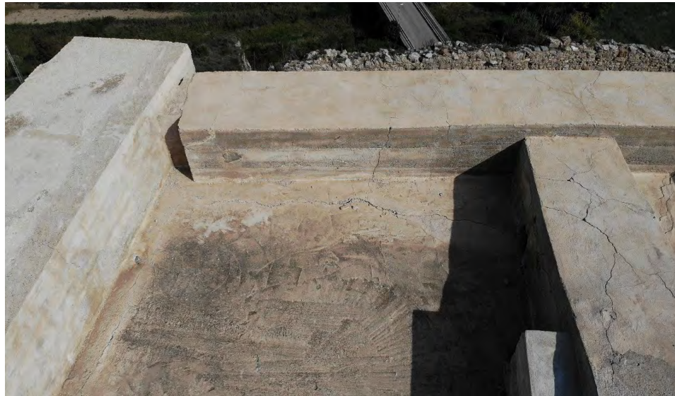
2022.10.13 Fissuracions en els terrats adjacents.
