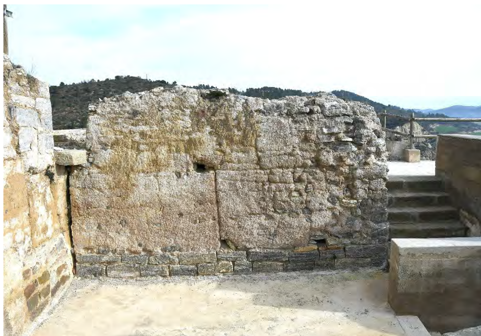
2020.02.07 La junta entre mur i paviment, on es concentren les filtracions
