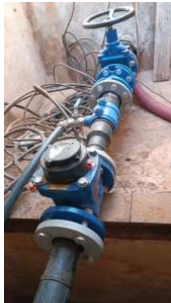
Imatge 8 – Estació de bombament
