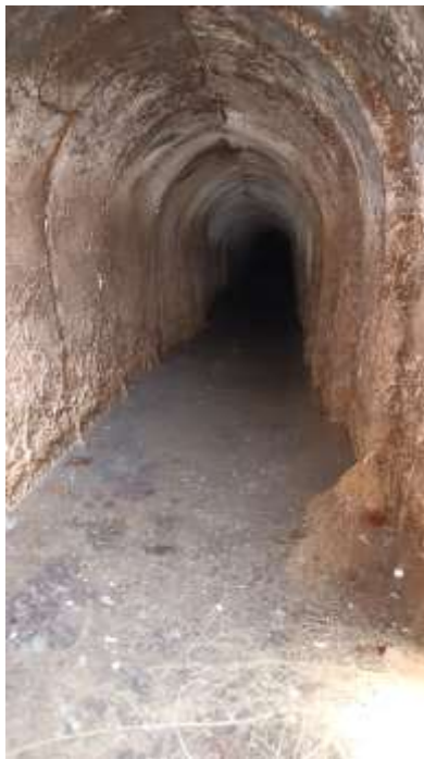
Imatge 4 – Captació mina
