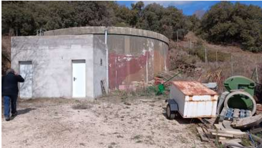
Imatge 9 – Dipòsit de 400 m 3
