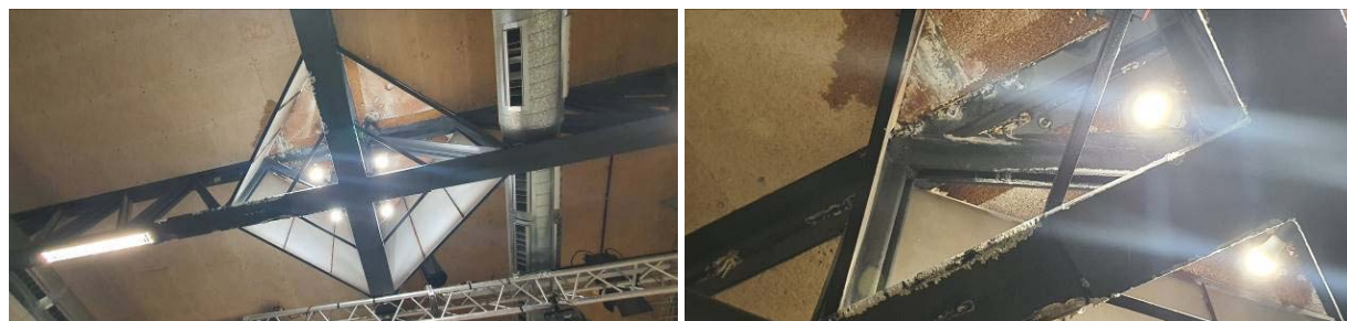
Sostre de la sala de concerts. Plaques adherides directament al forjat. En episodis de pluja presenta goteres per deficiències en la impermeabilització de coberta
