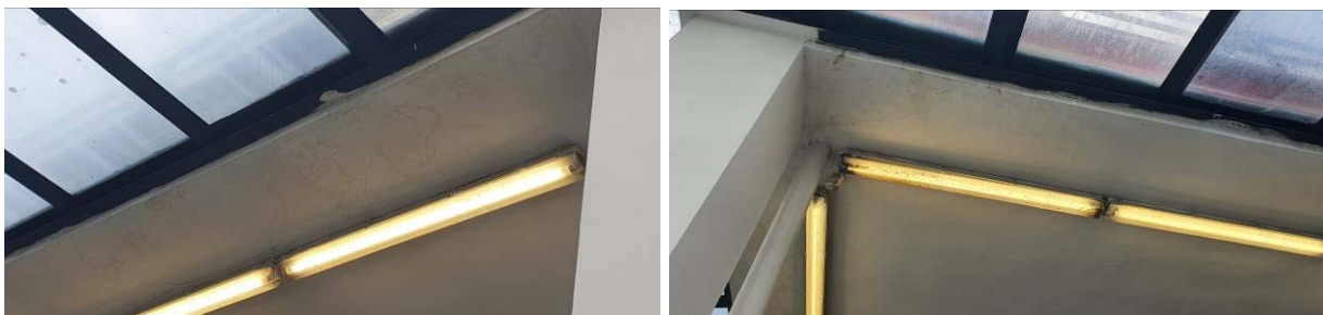
Entrega per la part interior de la coberta de vidre amb el pla de façana superior. Filtracions per mal estat del segellat
