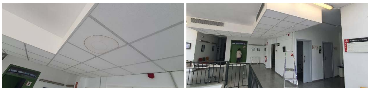
Vestíbul de planta primera. Humitats en fals sostre per degoteig de maquinària de climatització.
