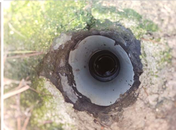
Baixant de coberta general amb connexió de tub de diàmetre 32. No s'observa la connexió del tub de diàmetre 160mm
