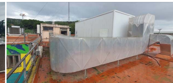
Conductes de climatització.
