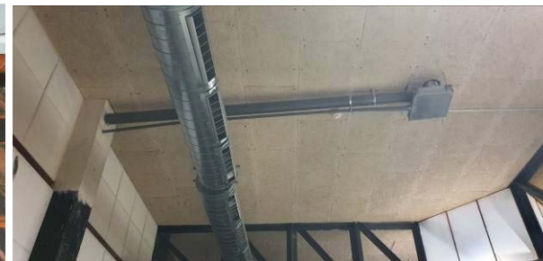
Sostre de la sala de concerts. Safata per recollir suposades filtracions dels colzes
