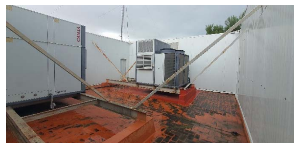
Unitats exteriors de climatització en recinte.
