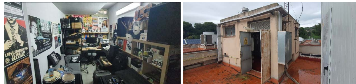
Tancament d'obertura en mal estat de fust amb cartrons per l'interior
