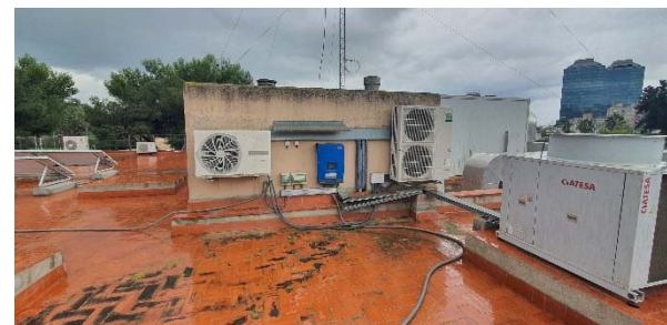
Unitat exterior de climatització damunt recrescut.
