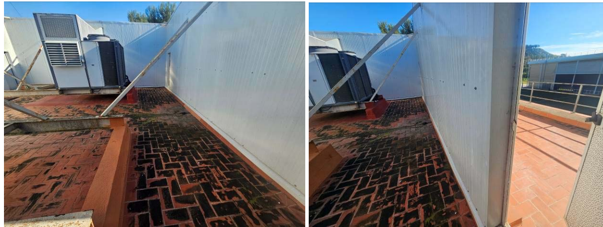
Bonera en interior del recinte connectada per sostre de la sala de concerts a baixant de coberta de general. S'observa una connexió amb tub de PVC de diàmetre 160mm i un empelt posterior amb tub de diàmetre 32mm.
