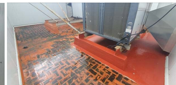
Unitats exteriors de climatització en recinte.
