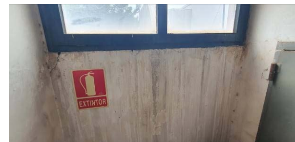
Filtracions d'aigua per fusteria de fusta
