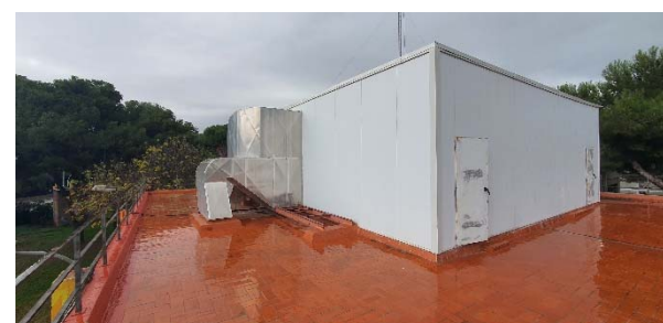
Cos central amb unitats exteriors de climatització
