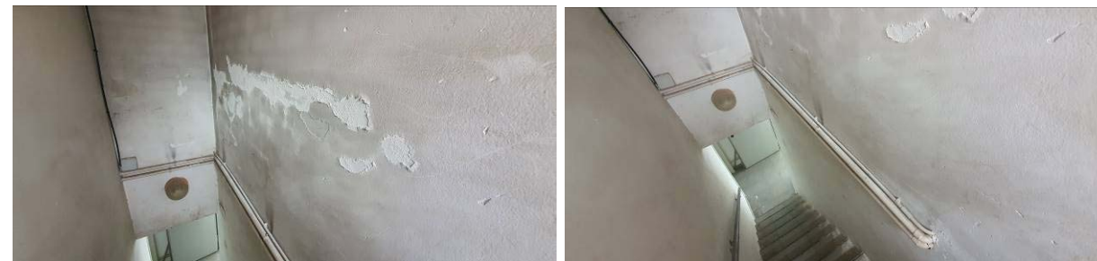
Humitats en tancament d'escala d'accés al badalot. Filtracions pel contacte amb la coberta general en nivell superior
