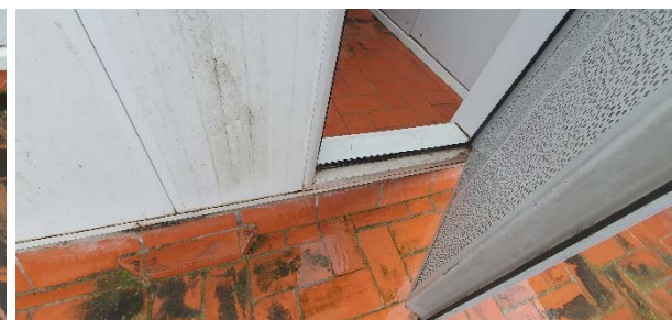
Remat inferior fora el recinte. A substituir
