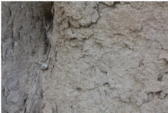
Detall d'un carreu de la portalada totalment debilitat per procés de disgregació del material petri.
