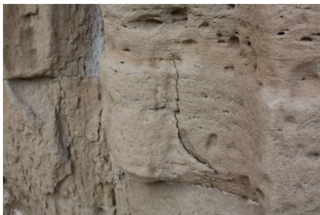
La fissuració del suport per pressions estructurals o per l'expansió de components poc estables com les argiles és el principi d'un procés que finalitza amb la desplaçació i pèrdua dels suport petri.
