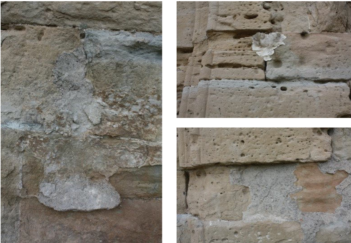
Alguns del morters de reparació que distorsionen la correcta lectura de la portalada.
