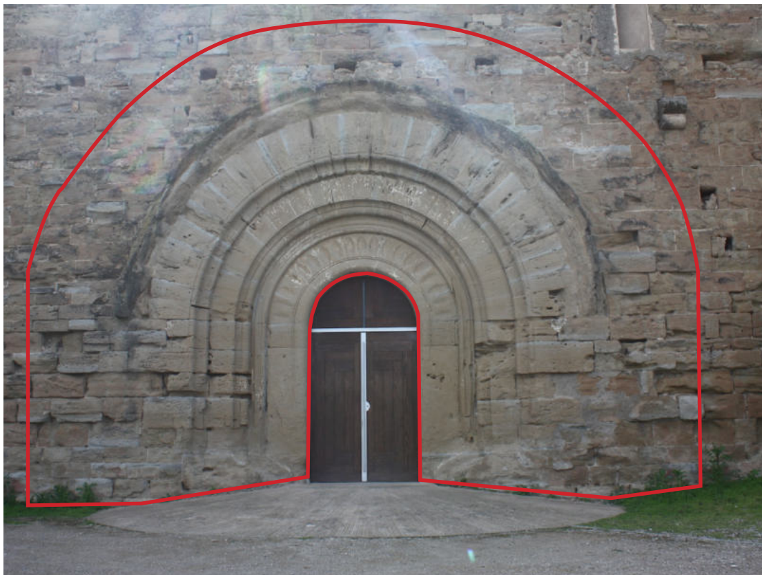
Vista general de la portalada principal de l'església de Santa Maria de Gardeny amb la superfície d'actuació prevista.
