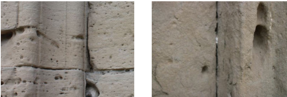
Dos exemples de pèrdua del morter de calç que omplia les fines juntes que uneixen els brancals de la portalada.
